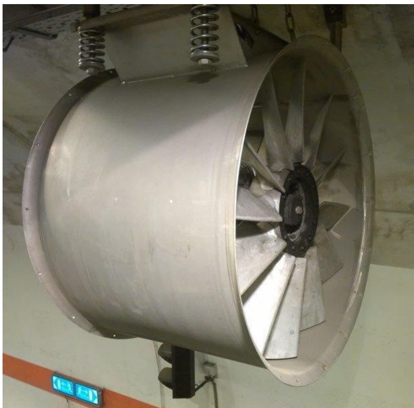
Slika 2. Ventilator u tunelu Mali Prolog
