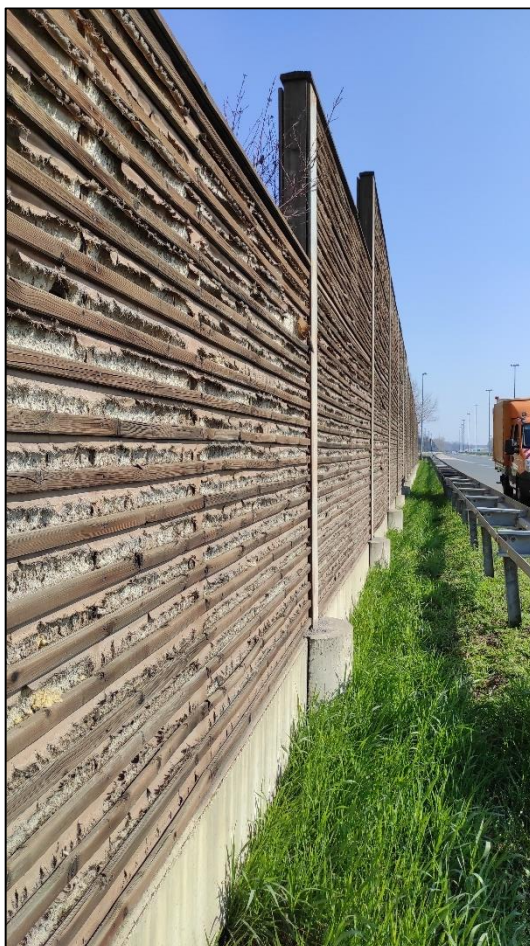
Slika 12. km 271+050.00 – karakteristično oštećenje drvenog panela primijećeno na cijeloj duljini zida
