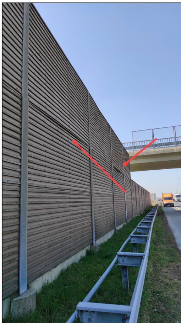
Slika 1. km 259+350.00 – oštećenje na panelima u 2. i 4. polju od nadvožnjaka
