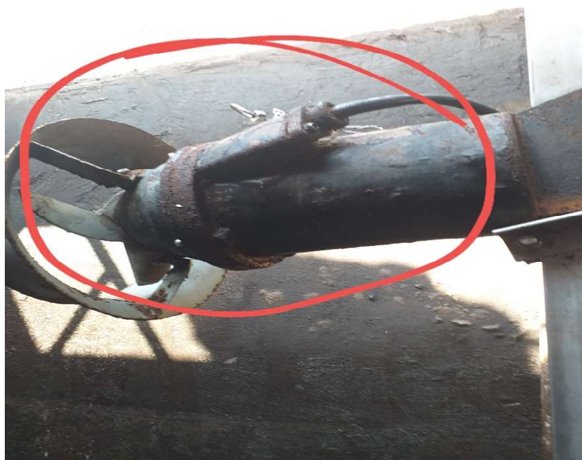
1.Mješač – potrebna zamjena – pregorio
