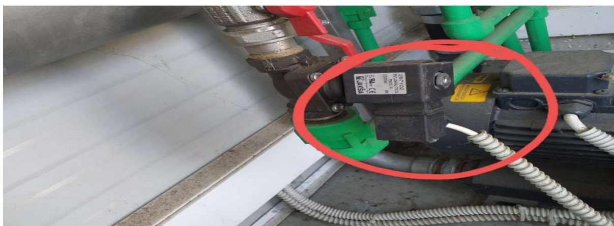
3. Elektromagnetni ventil – potrebna zamjena
