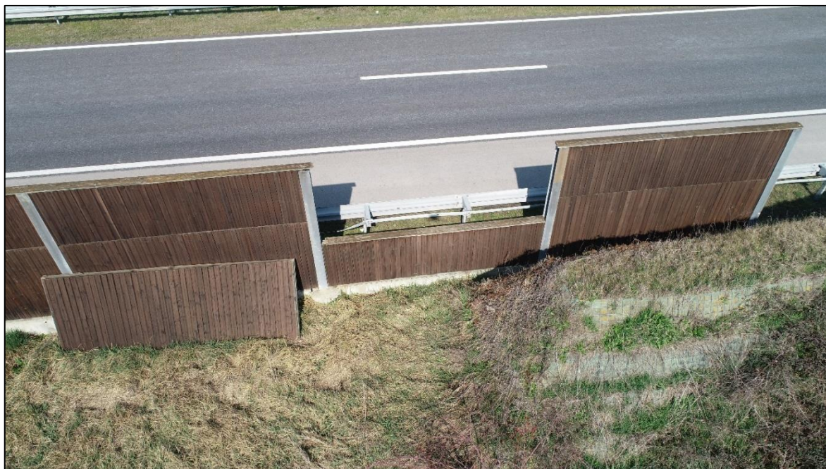
Slika 9. km 268+700.00 – drveni panel koji nedostaje na jednom polju zida za zaštitu od buke
