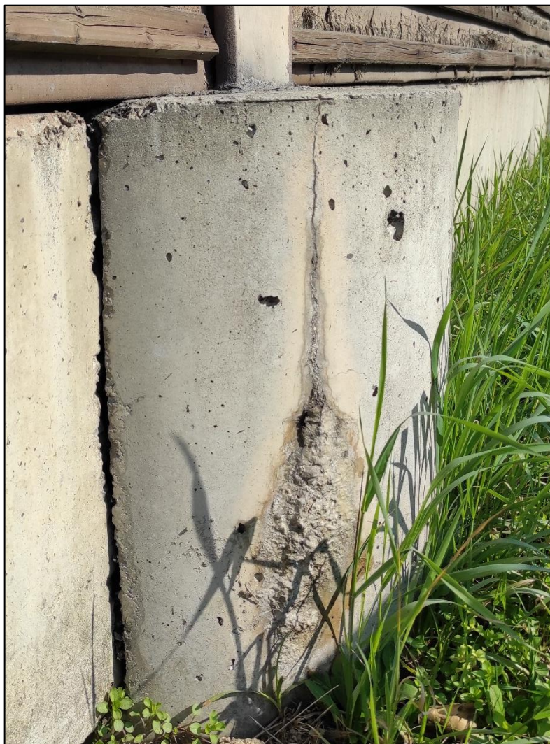
Slika 14. km 271+050.00 – karakteristično oštećenje glava pilota prisutno po cijeloj duljini konstrukcije zida za zaštitu od buke
