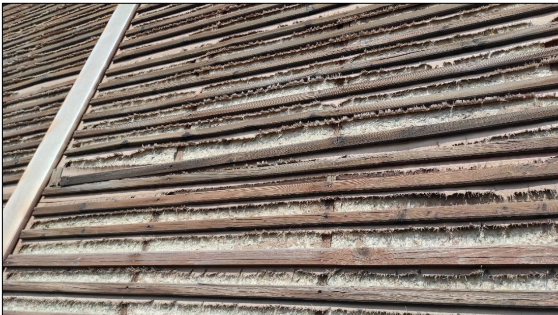
Slika 13. km 271+050.00 – stanje drvenih panela s prednje strane zida za zaštitu od buke
