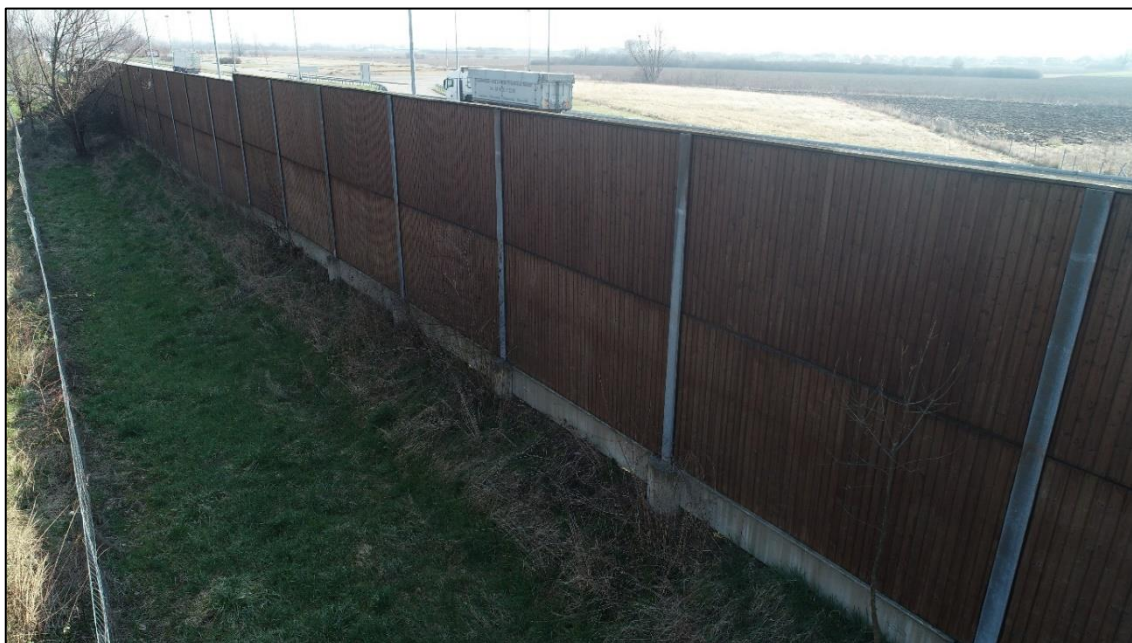
Slika 15. km 271+050.00 – stanje panela sa stražnje strane zida za zaštitu od buke
