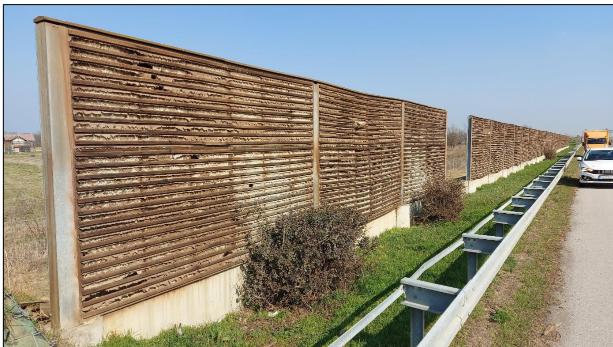
Slika 8. km 260+650 – polje ZZOB na kojem nedostaju paneli i karakteristično oštećenje susjednih polja
