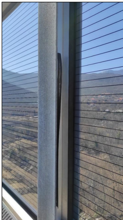
Slika 7. Oštećenje gume na spojevima
