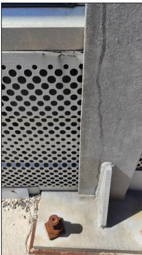
Slika 8. Oštećenje metalnog panela / korozija sidrenog vijka
