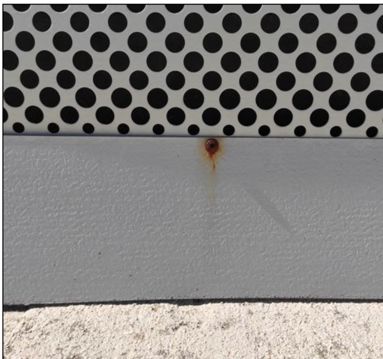
Slika 9. Lim između metalnog panela i gornje kote vijadukta / korodirana blok zakovica
