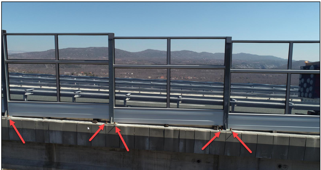
Slika 5. Pozicije korodiranih sidrenih vijaka
