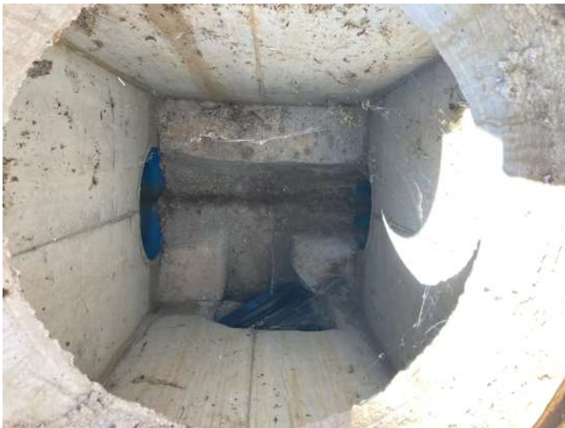
Slika 4. Karakteristično revizijsko okno zauljene odvodnje ROz_4.2
