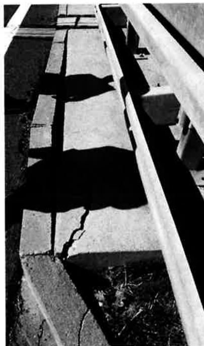
Slika 6_ Oštećenje rubnjaka i dijela sjeverne staze iznad upornjaka U2. Na slici je vidljivo i proklizavanje asfalta te boranje uz rubnjake.
