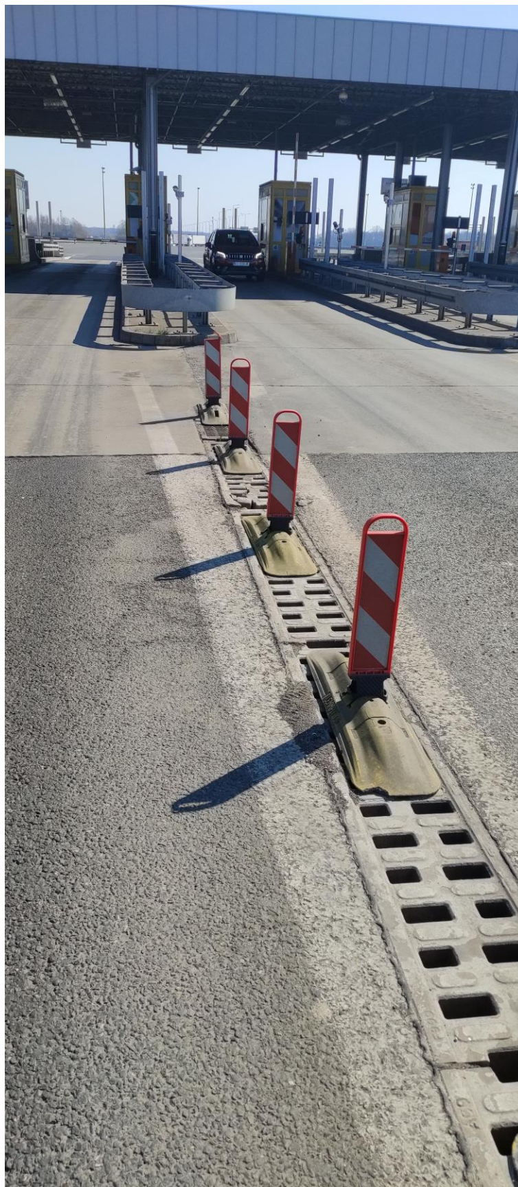
Slika 2. Izlazna strana NP Zagreb istok i oštećeni linijski kanal ( pogled u smjeru istoka )
