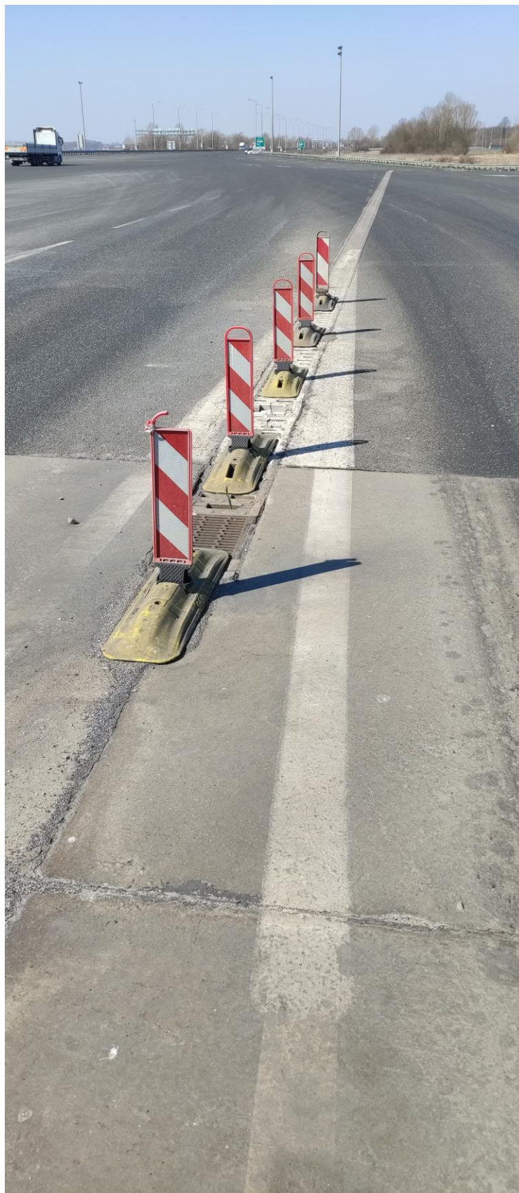
Slika 3. Izlazna strana NP Zagreb istok i oštećeni linijski kanal ( pogled u smjeru zapada )
