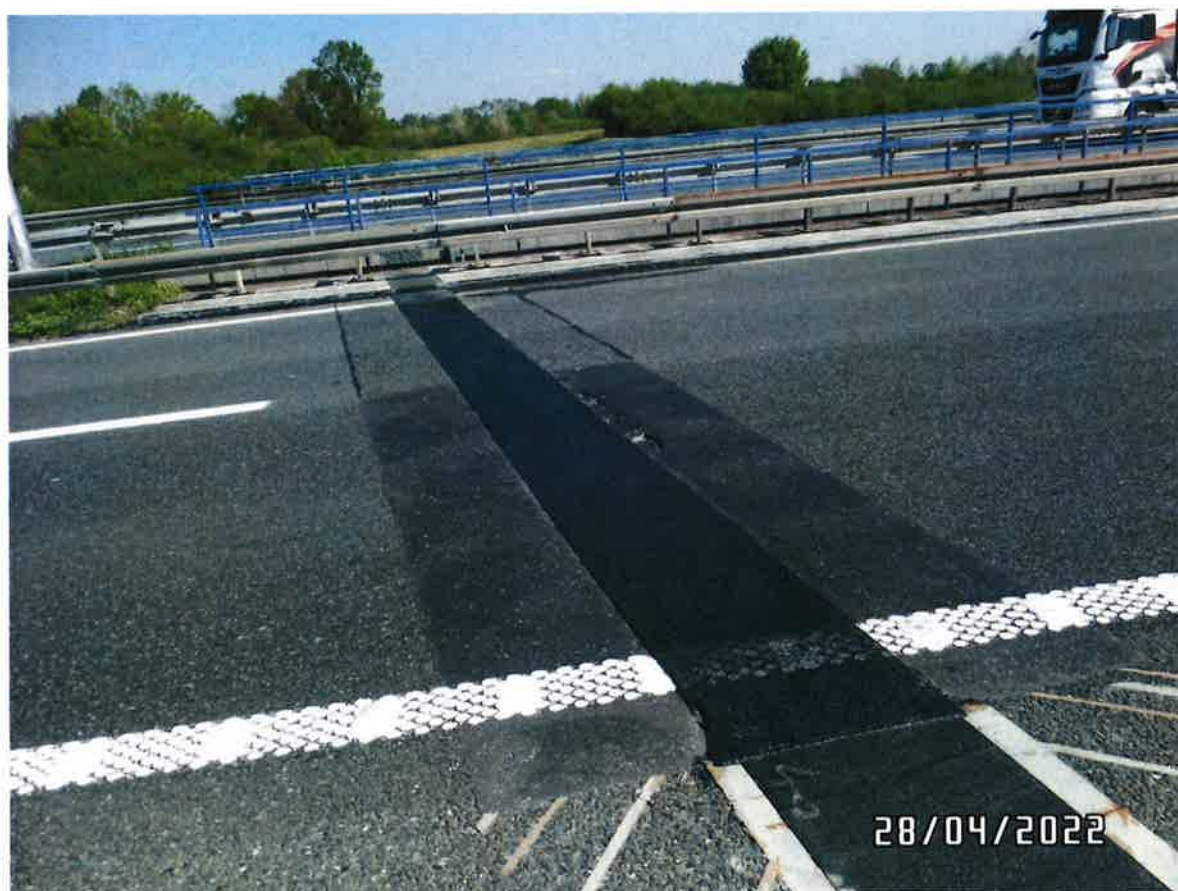
Slika 1.1 Pogled na prvu prijelaznu napravu (gledano u smjeru Sl. Broda) – vidljiva oštećenja nakon sanacije
