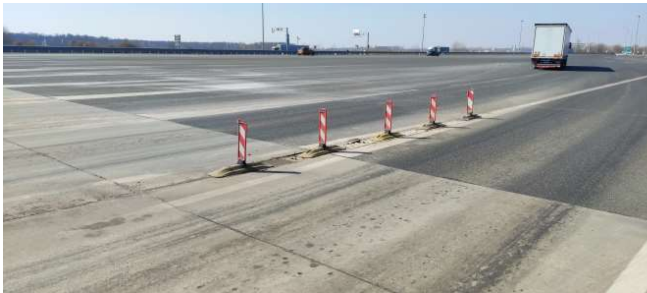
Slika 1. Oštećeni kanal linijske odvodnje između staza 4 i 5 ( izlazna strana NP Zagreb istok )
