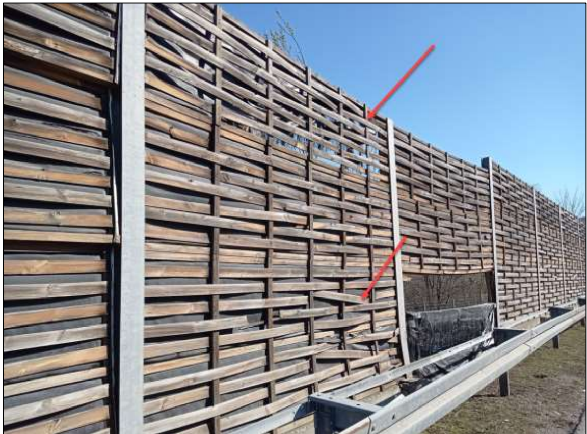
Slika 6. Oštećenje susjednih polja zida za zaštitu od buke
