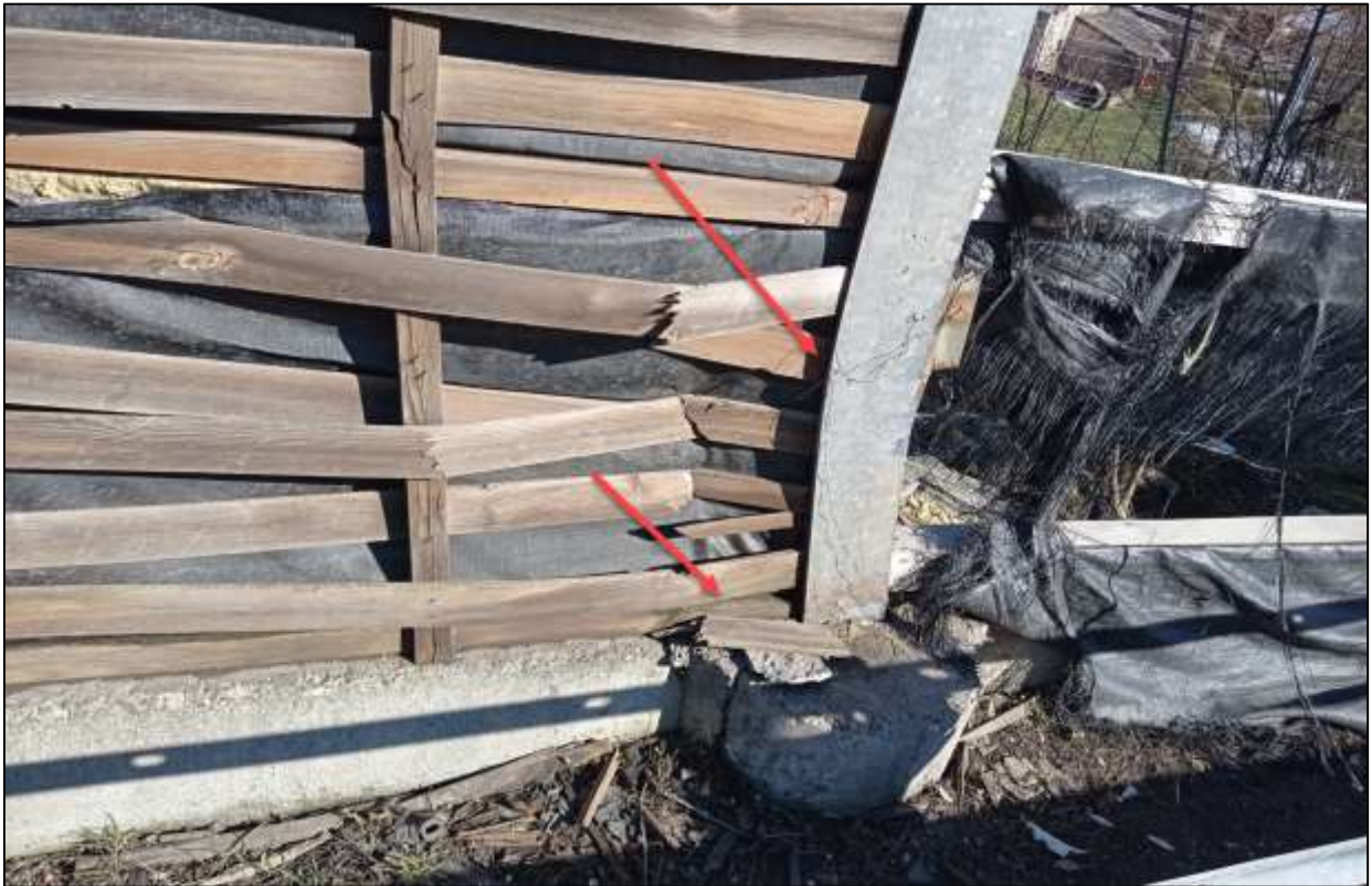
Slika 5. Oštećenje HEA stupa i glave pilota
