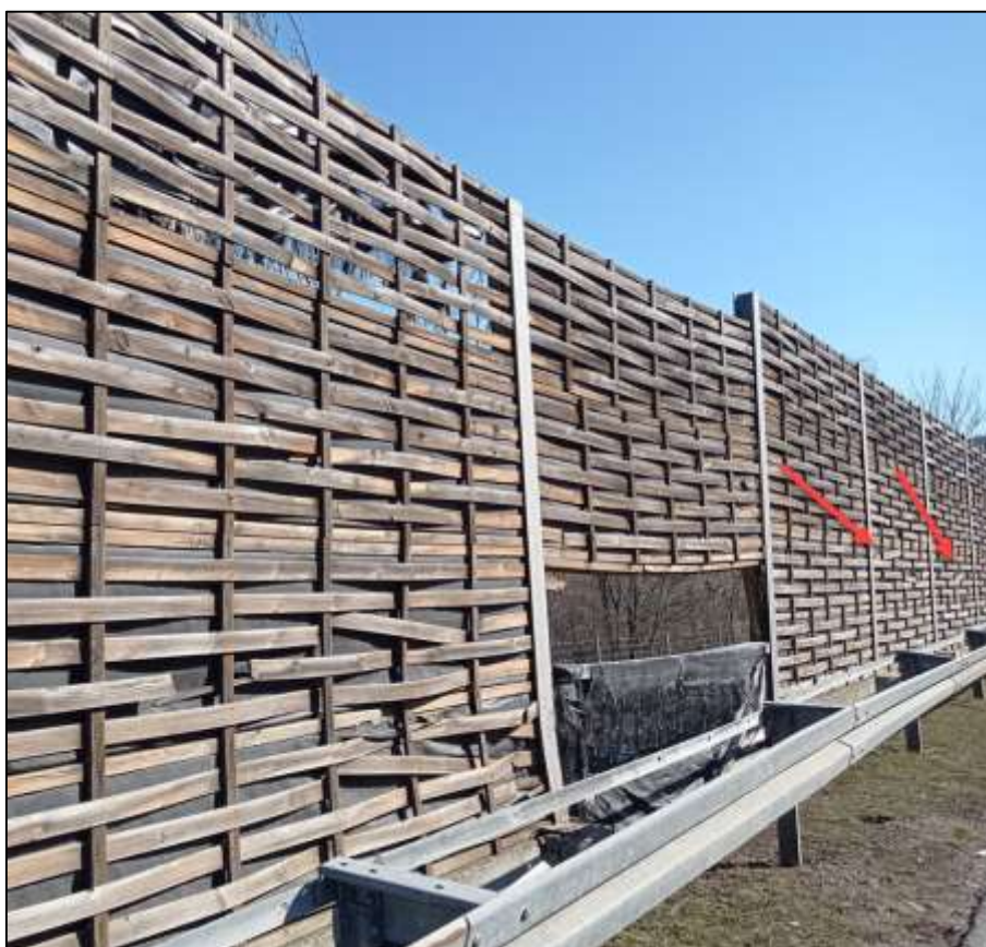
Slika 8. Oštećenje ispune susjednih polja zida za zaštitu od buke
