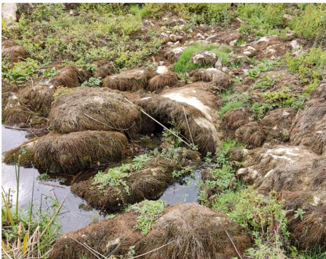
Slika 6. Prikaz oštećenog i zapunjenog cijevnog propusta ispod nasipa.
