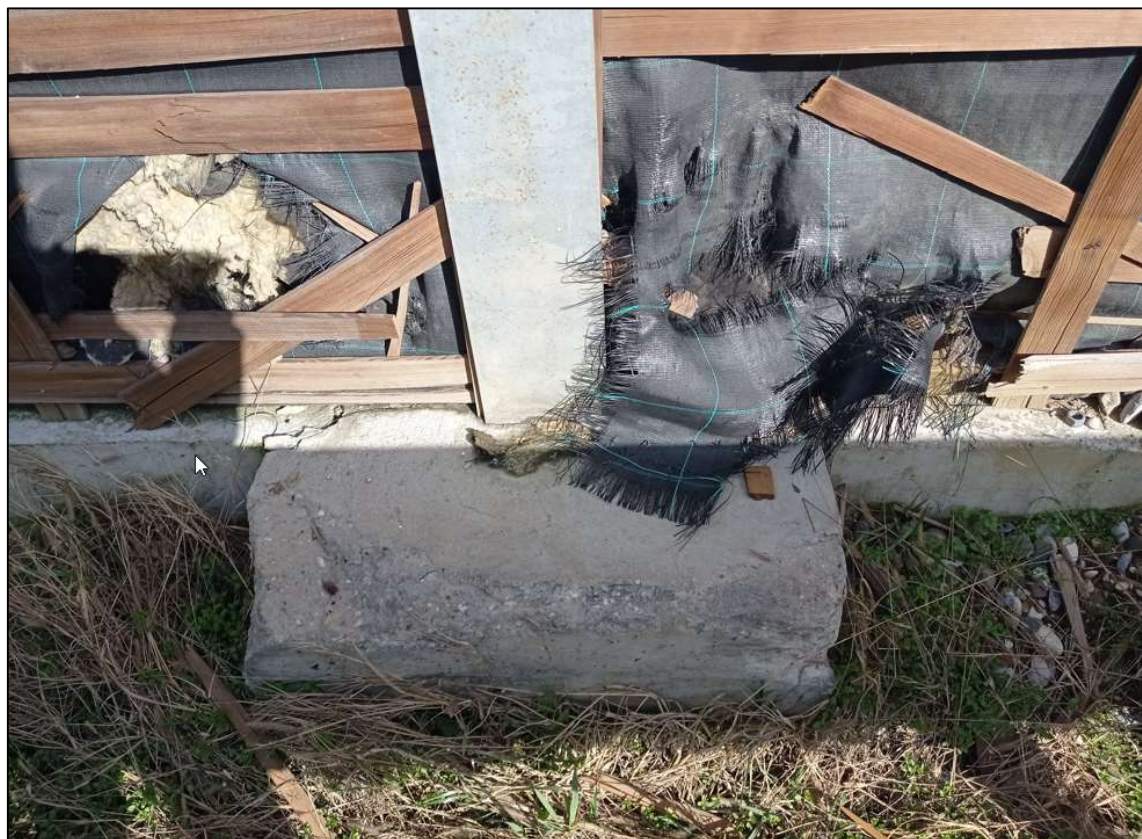
Slika 10. km 107+980.00 – oštećenje čašice i naglavne grede
