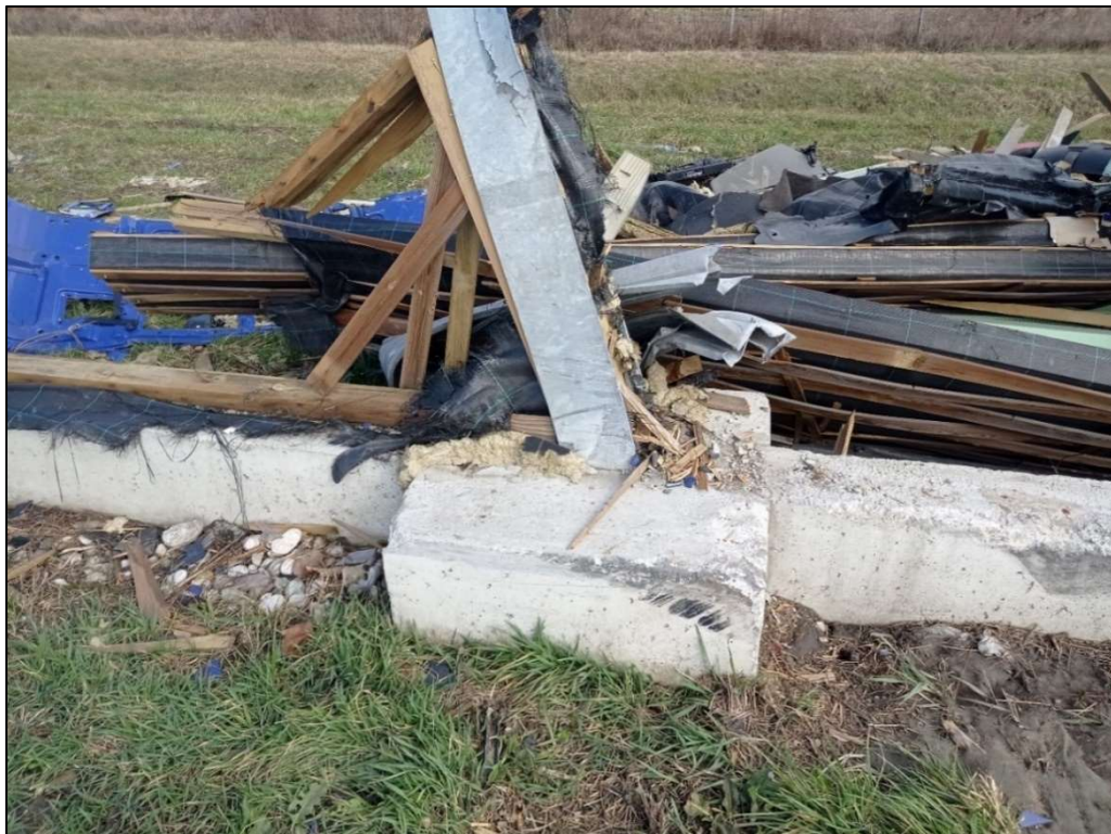
Slika 4. km 105+205.00 – oštećenje čašice i naglavne grede na poziciji HEA profila oznake 2 (vidi Slika 2.)
