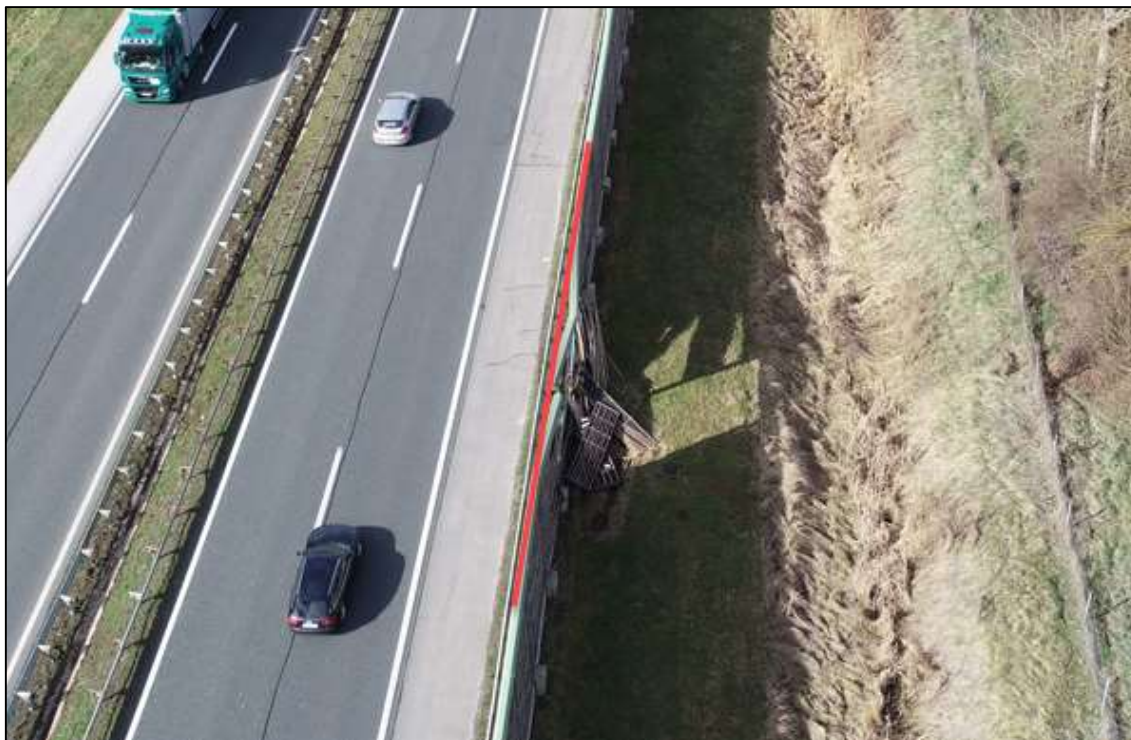
Slika 11. km 107+980.00 – izmicanje iz ravnine zida za zaštitu od buke
