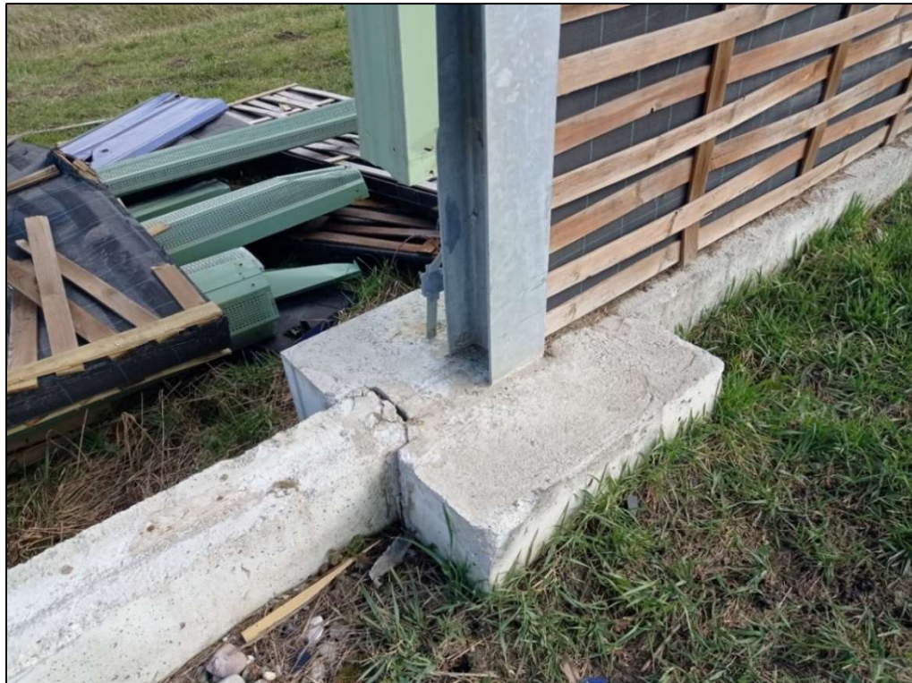
Slika 3. km 105+205.00 – oštećenje čašice i naglavne grede na poziciji HEA profila oznake 1 (vidi Slika 2.)
