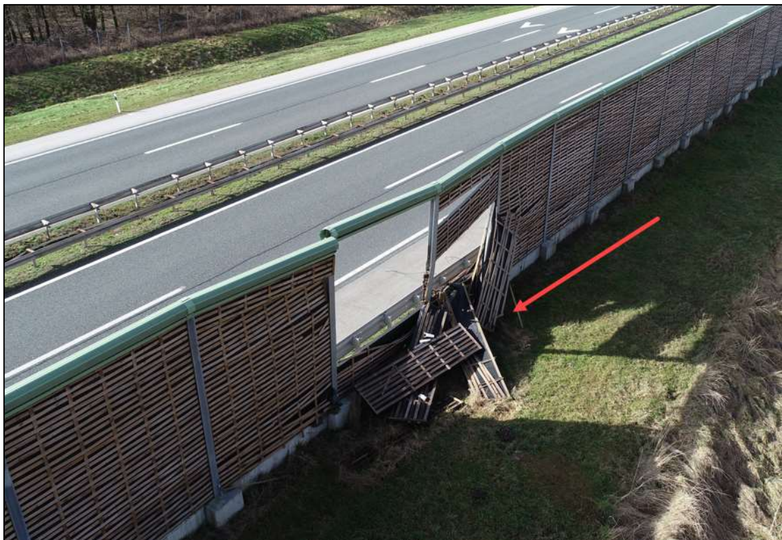
Slika 8. km 107+980.00 – neuklonjeni oštećeni dijelovi zida
