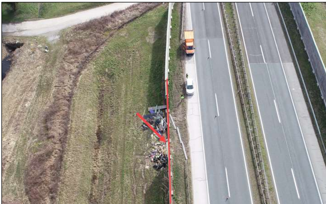
Slika 6. km 105+200.00 – zid izmaknut iz ravnine
