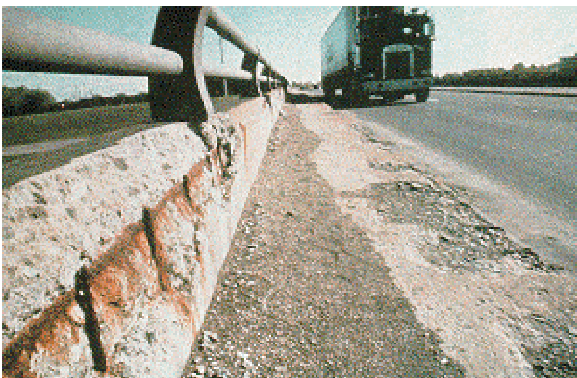
potpuno razaranje betona i izložene korodirane šipke
