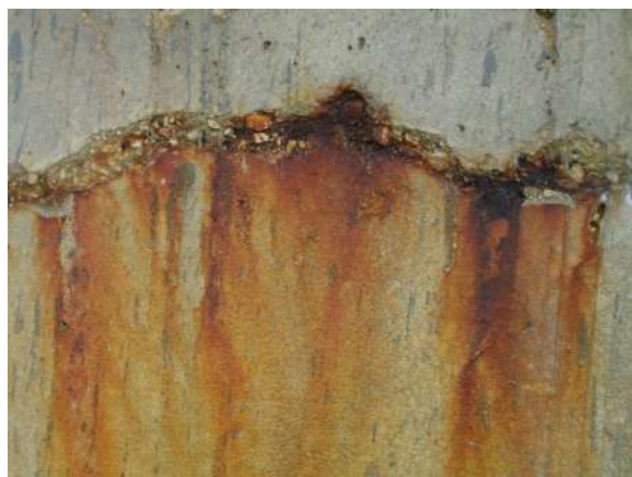
horizontalna pukotina u zidu upornjaka
