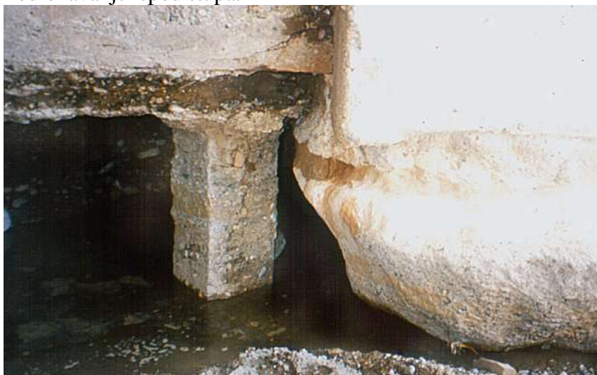
Podlokavanje ispune ispod upornjaka uslijed protoka vode
