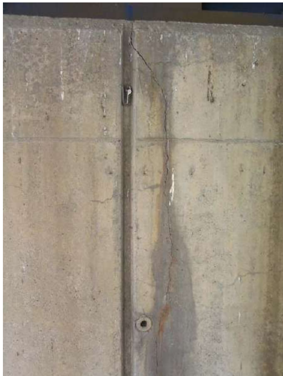
vertikalna pukotina u zidu upornjaka
