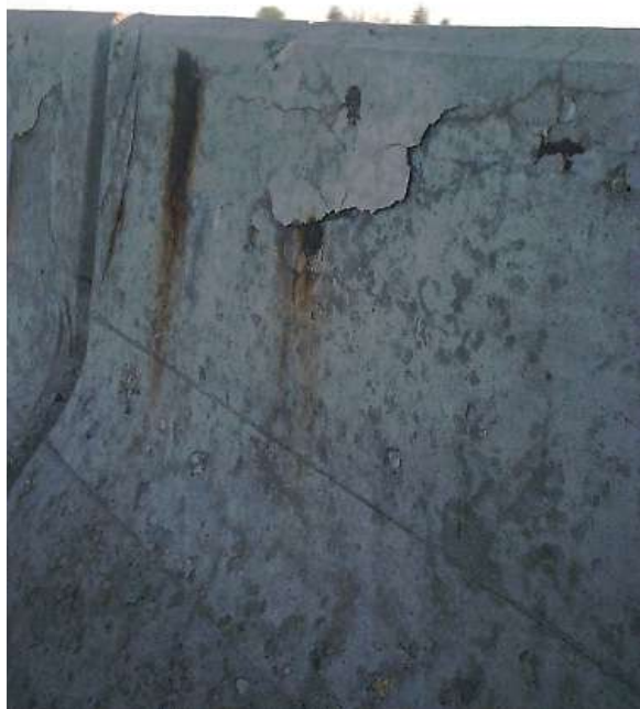
ljuštenje sa smeđim mrljama od korozije
