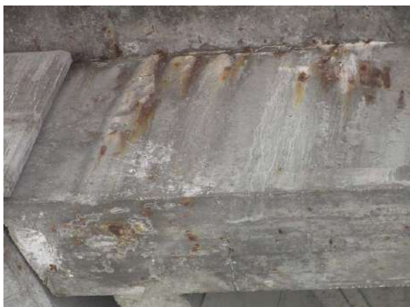
smeđe mrlje od korozije na glavnim nosačima
