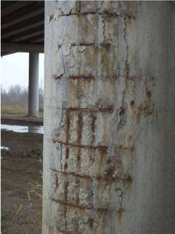
odlamanje betona s izloženom armaturom
