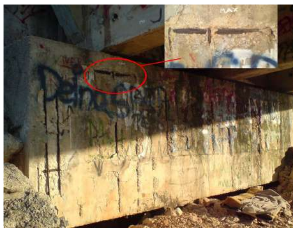
odlamanje betona i izložene šipke armature
