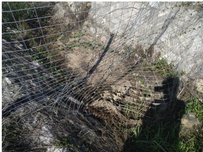
Oštećenja ZŽO uslijed djelovanja oborinske vode
