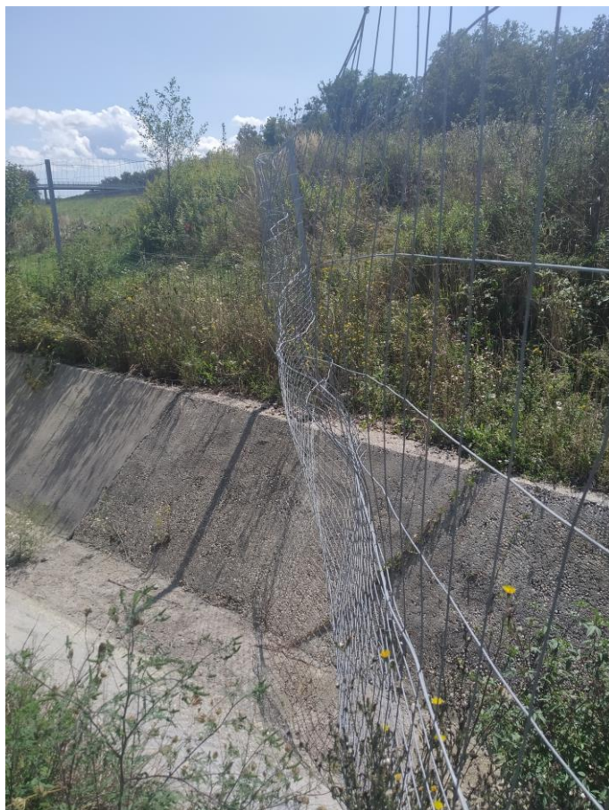
Oštećenja ZŽO uslijed djelovanja oborinske vode
