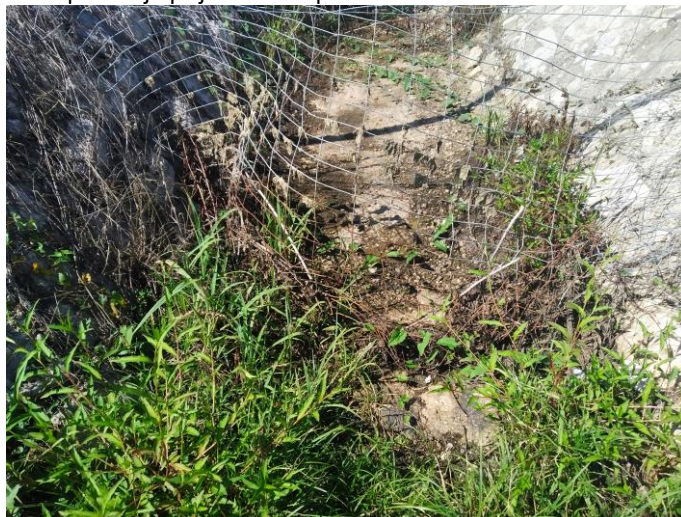
Oštećenja ZŽO uslijed djelovanja oborinske vode
