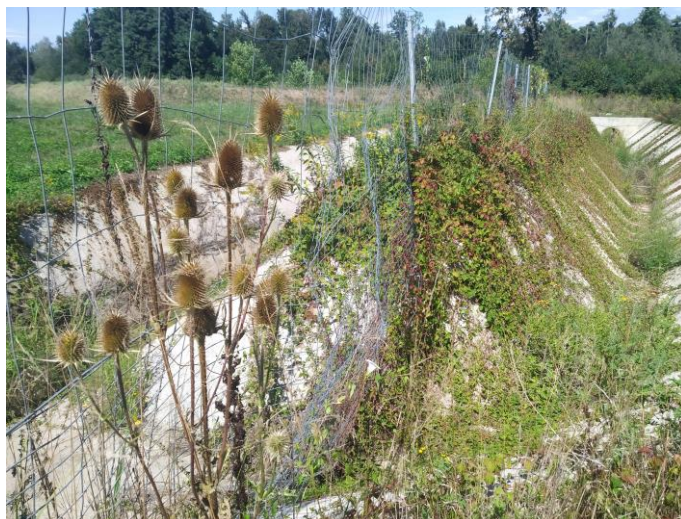
Oštećenja ZŽO uslijed djelovanja oborinske vode
