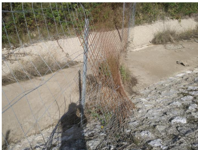
Odvajanje ZŽO od nosača u km 24+600 desno
