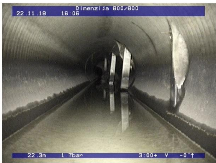
Slika 1 - Kolizija cjevovoda i stupića ograde (vidljivo je zadržavanje vode sa finim česticama lapora u donjem dijelu cjevovoda)
