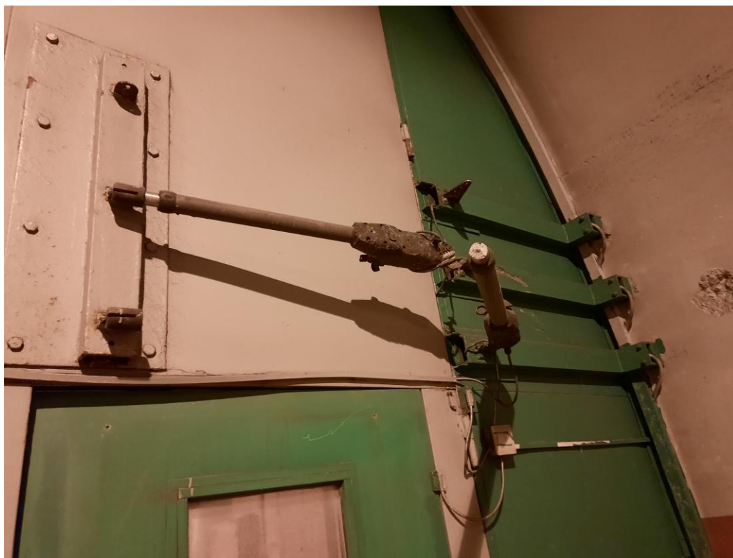
Prikaz oštećenja vrata
