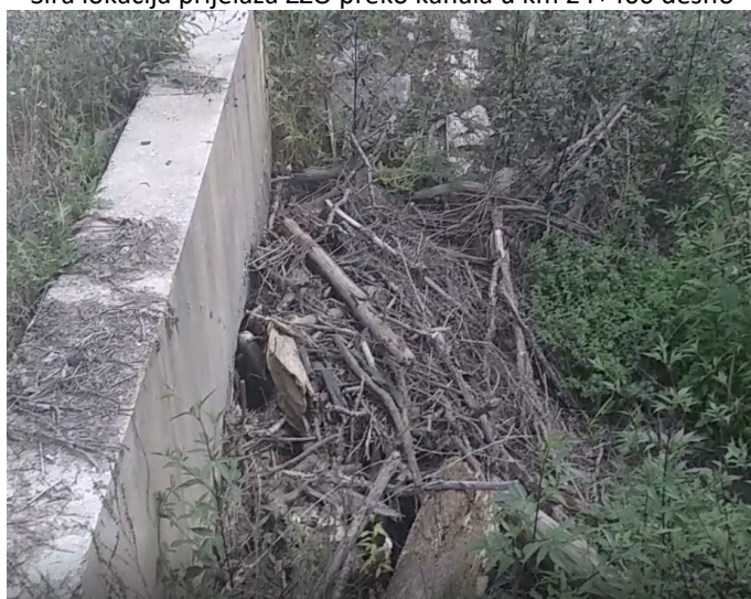
Zatrpan ulaz u cijevni betonski propust
