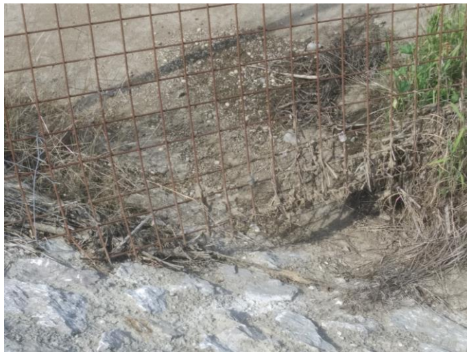
Postojeći otvor u ZŽO u km 24+600 desno
