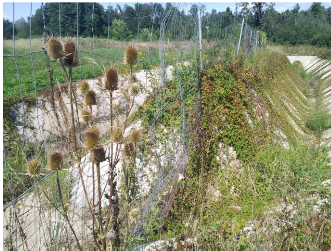
Oštećenja ZŽO uslijed djelovanja oborinske vode
