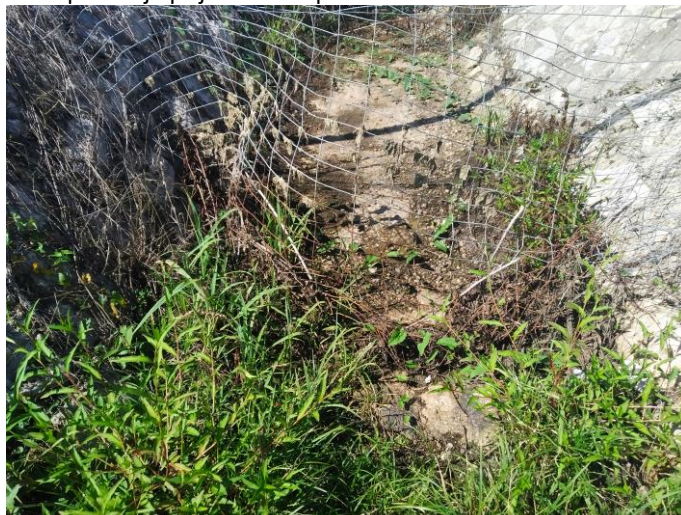
Oštećenja ZŽO uslijed djelovanja oborinske vode
