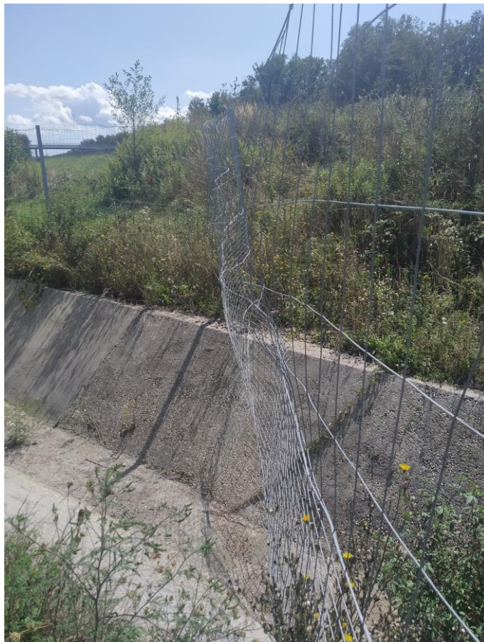
Oštećenja ZŽO uslijed djelovanja oborinske vode
