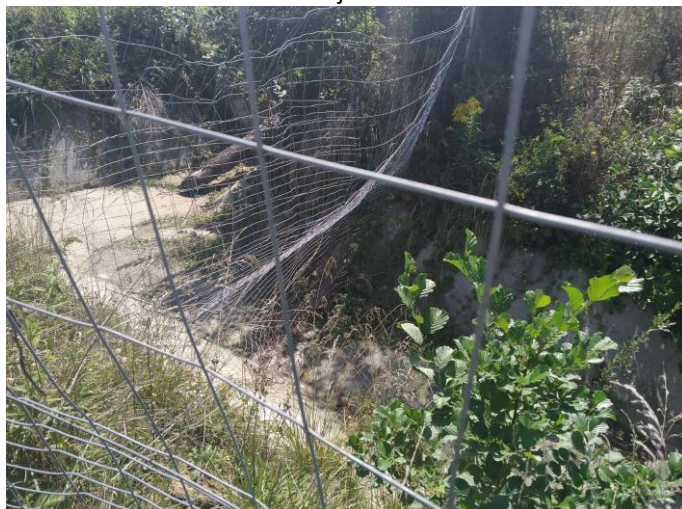
Izobličenje ZŽO uslijed djelovanja oborinski voda
