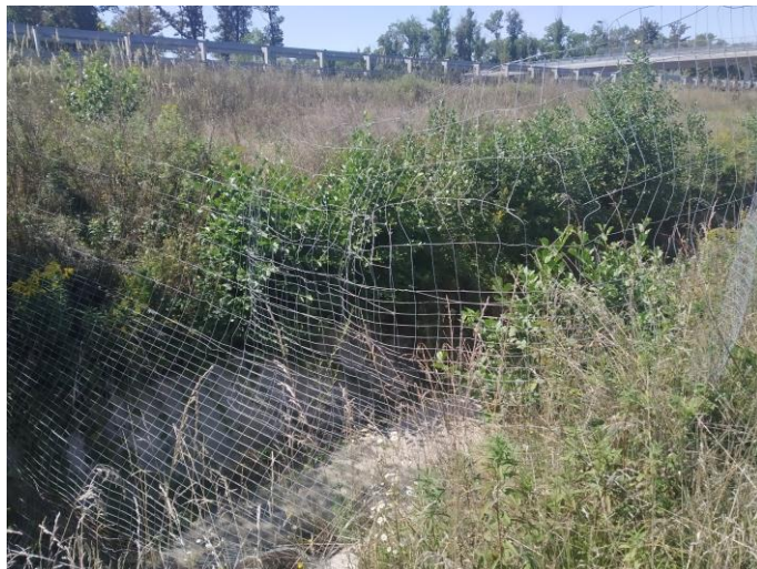
Nepravilno izvedeno oblikovanje žice, nedostaje stup nosač na zavoju žice
