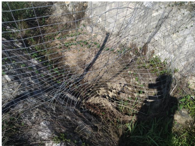
Oštećenja ZŽO uslijed djelovanja oborinske vode
