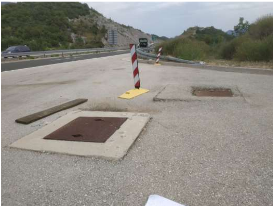
Slika 2: Izdignuti i ulegnuti položaj šahtova u odnosu na ravninu platoa i pukotine u asfaltnom zastoru
