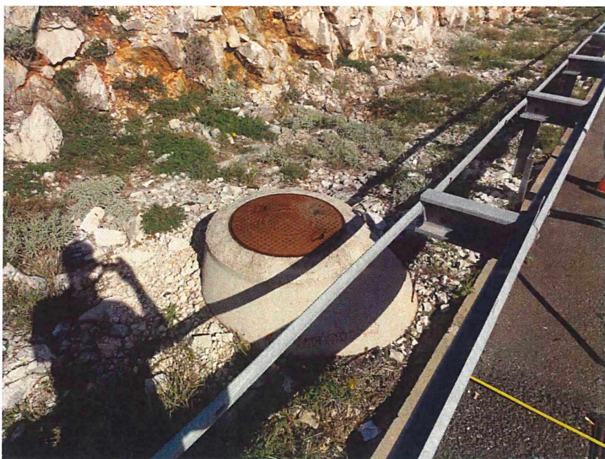
Postojeći sustav oborinske odvodnje (u bermi) na koji se rešetka spaja
