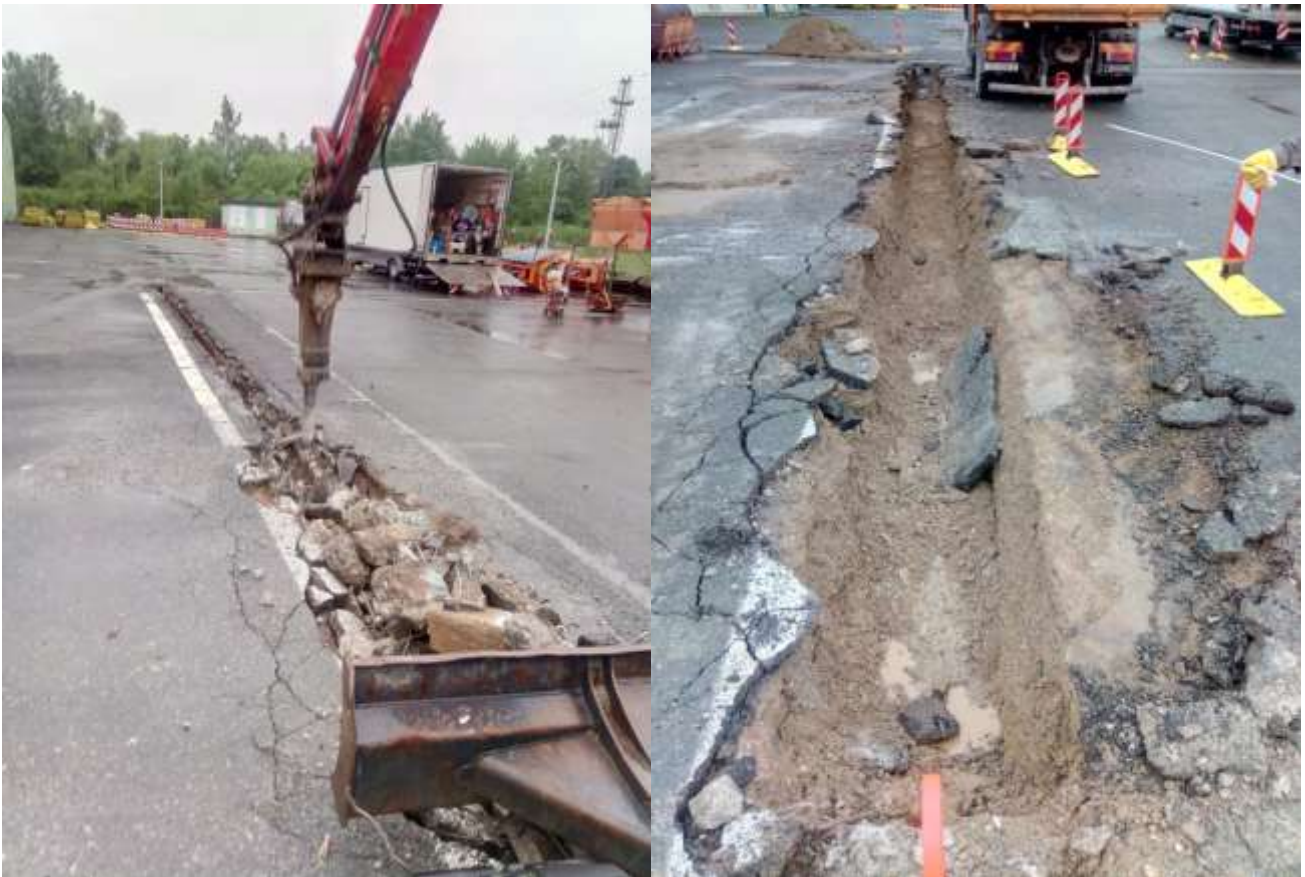
Slika 20: Očekivana oštećenja asfalta prilikom vađenja kanalica
