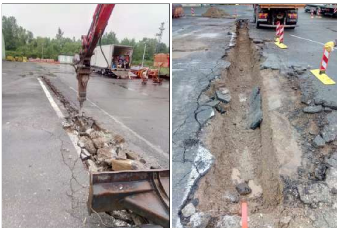
Slika 6: Očekivana oštećenja asfalta prilikom vađenja kanalice
