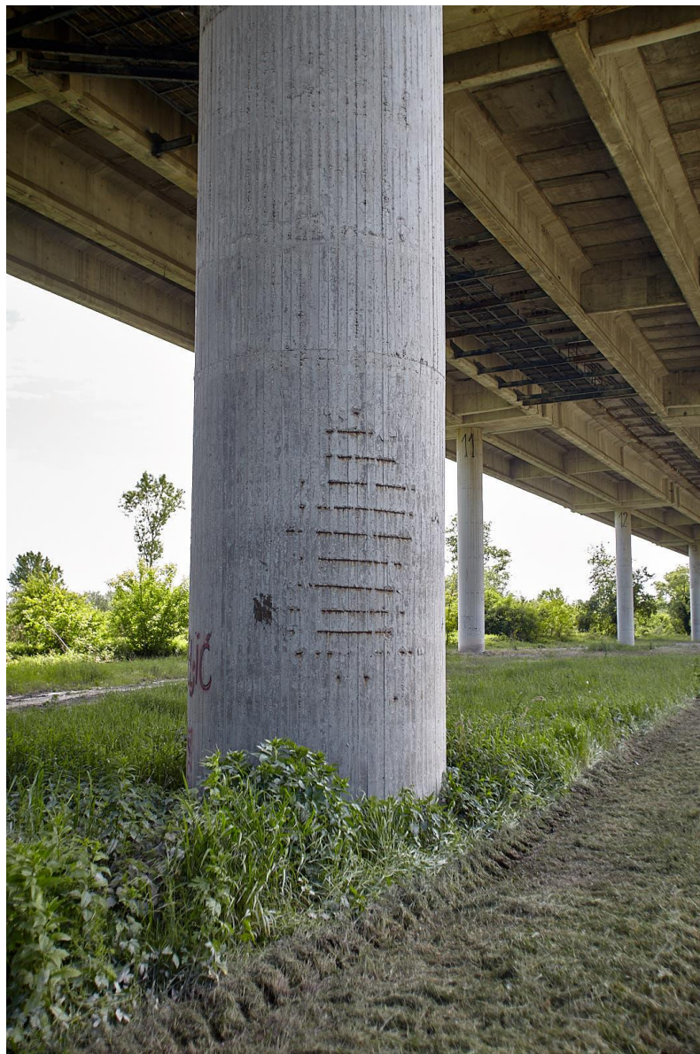
Slika 1 Oštećenje stupa S14 u inundaciji, posljedica nekvalitetne izvedbe
