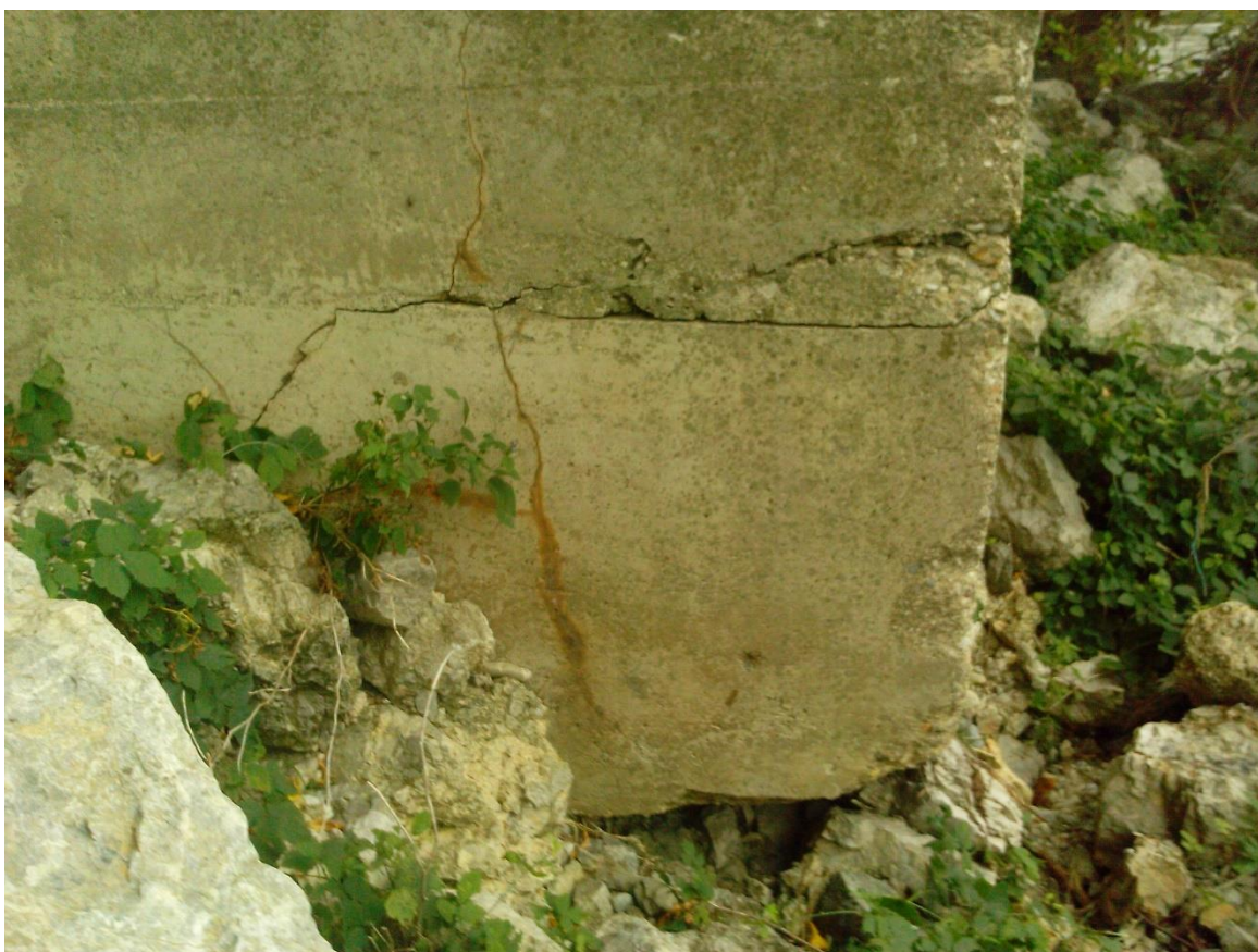
Slika 8 Pukotina naglavne grede temeljne stope stupa S16/1
