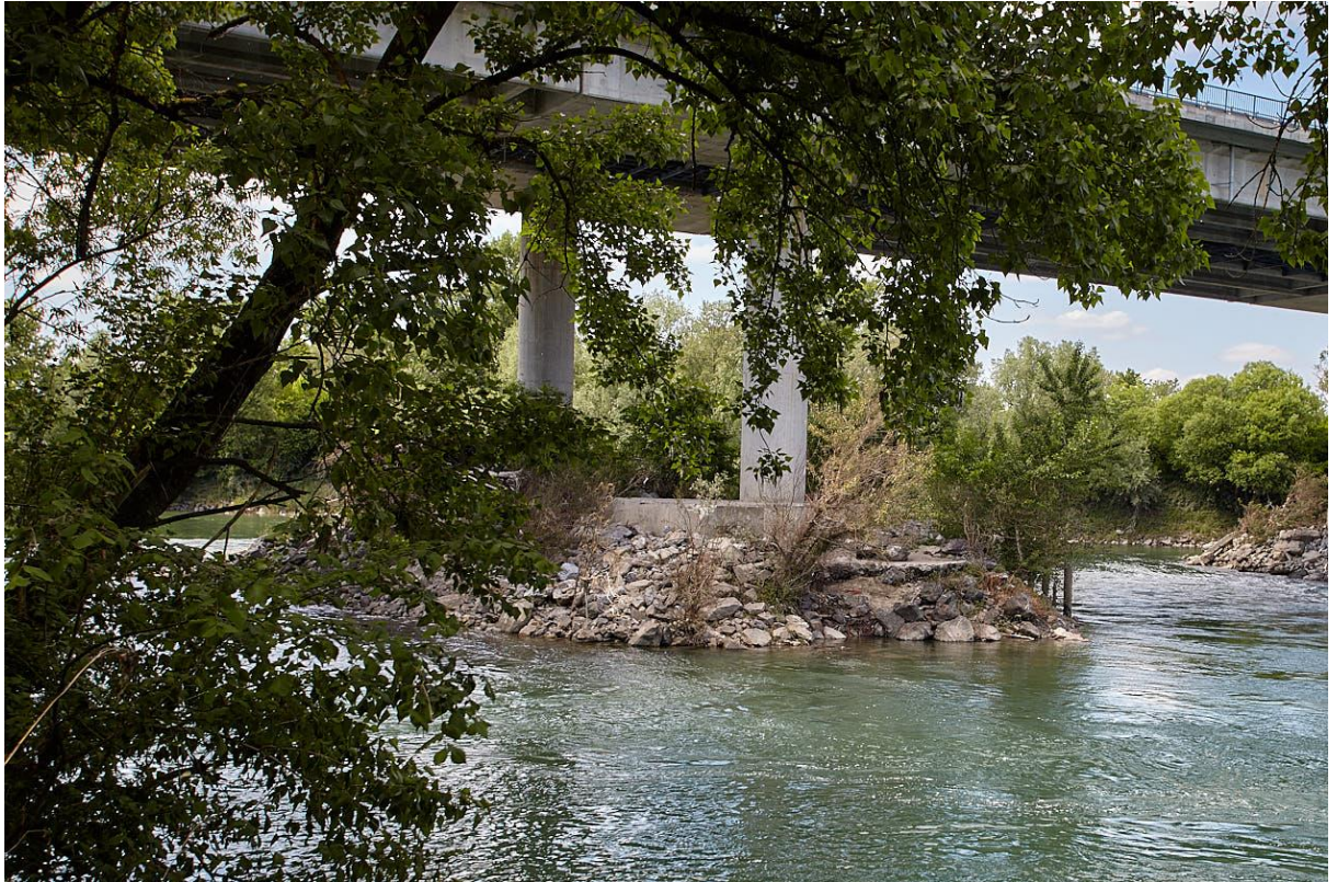
Slika 5 Potkopavanje korita ispod nožice kamenog nabačaja stupišta S15 i njegovo urušavanje u kaverne
