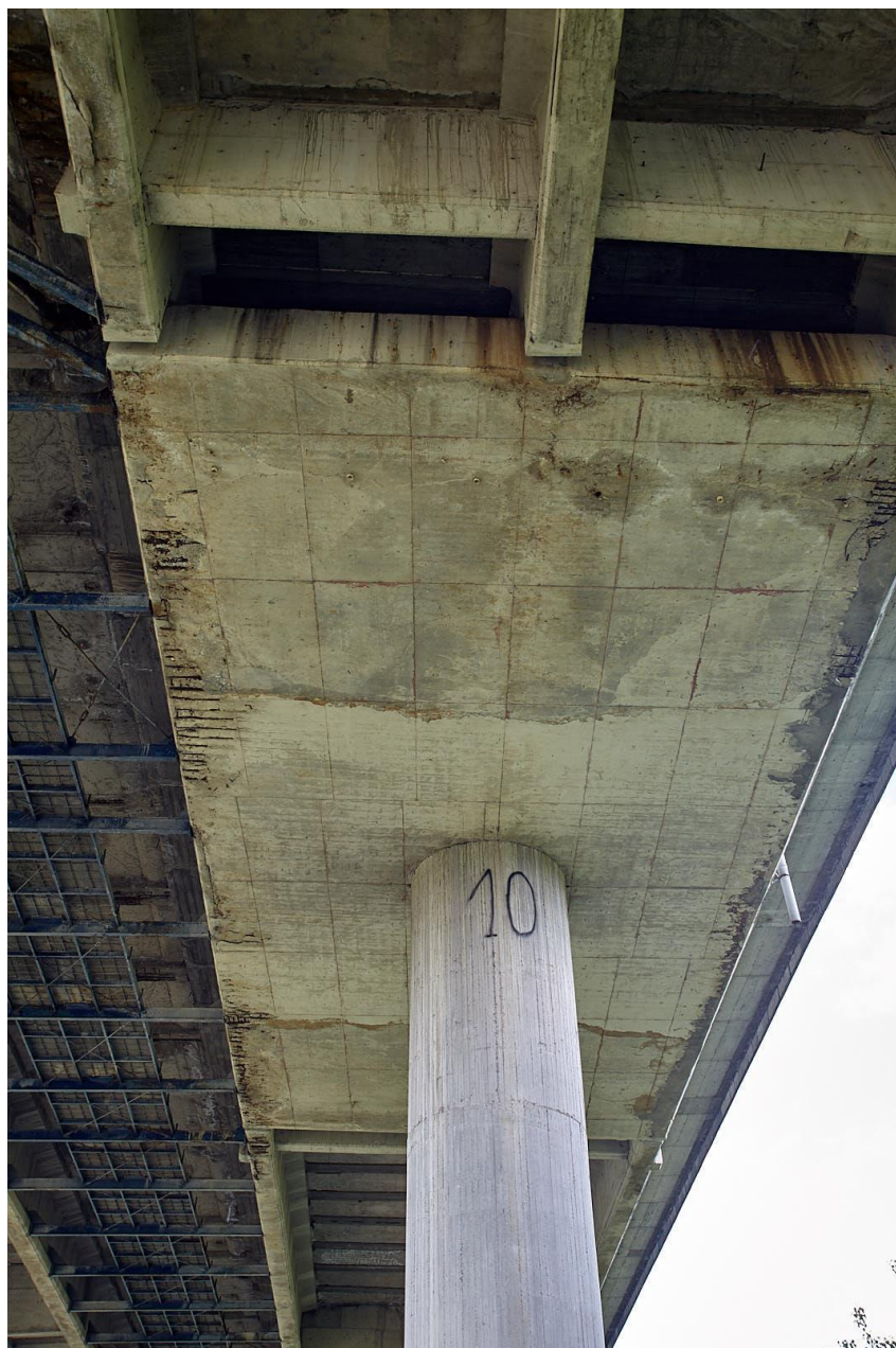
Slika 2 Oštećenje naglavnice stupa zbog procjeđivanja vode kroz prijelaznu napravu
