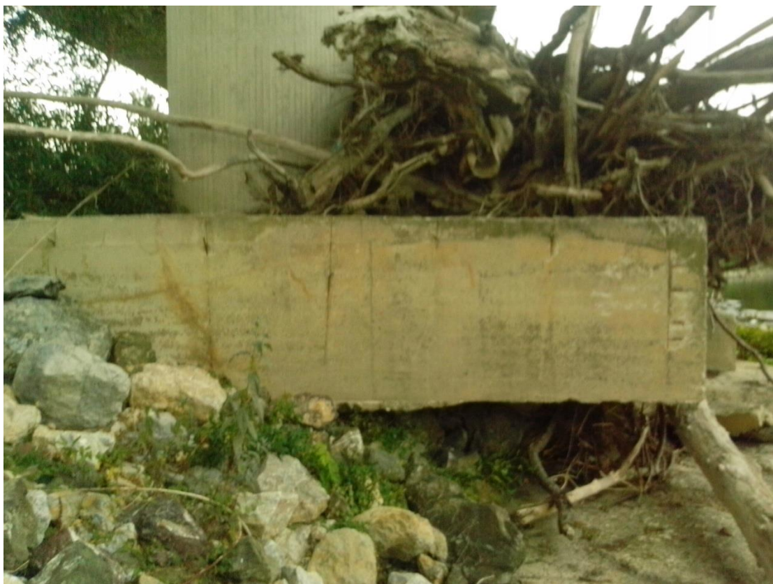
Slika 7 Rupa ispod uzvodnog lica temeljne stope stupa S15/2 s uzvodne strane
