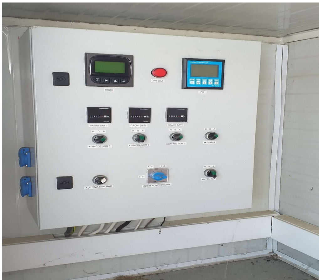
Slika upravljačkog ormara – vidi se da je uređaj isključen i nije u pogonu
