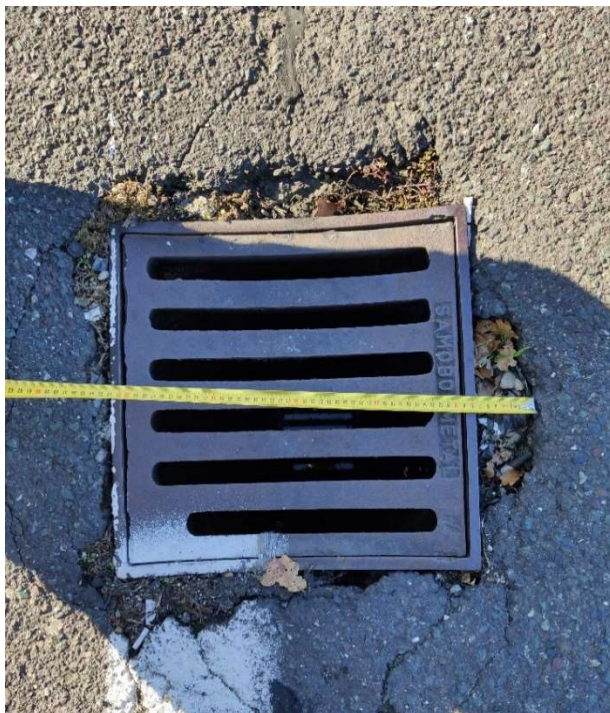
Fotografija 1: Oštećenja na slivniku 1
