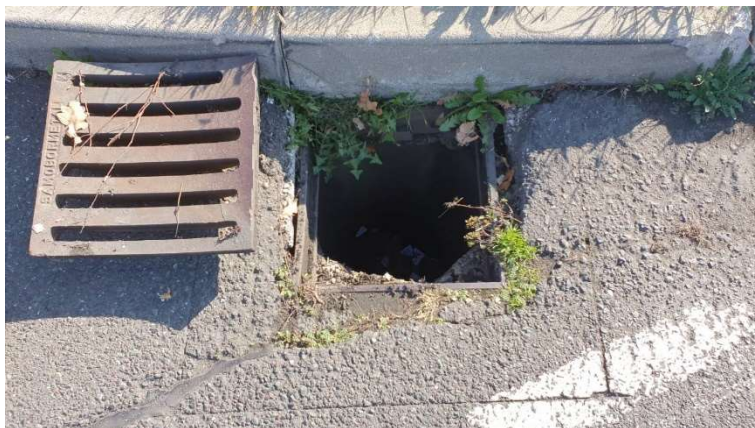
Fotografija 2: Oštećenja na slivniku 2
