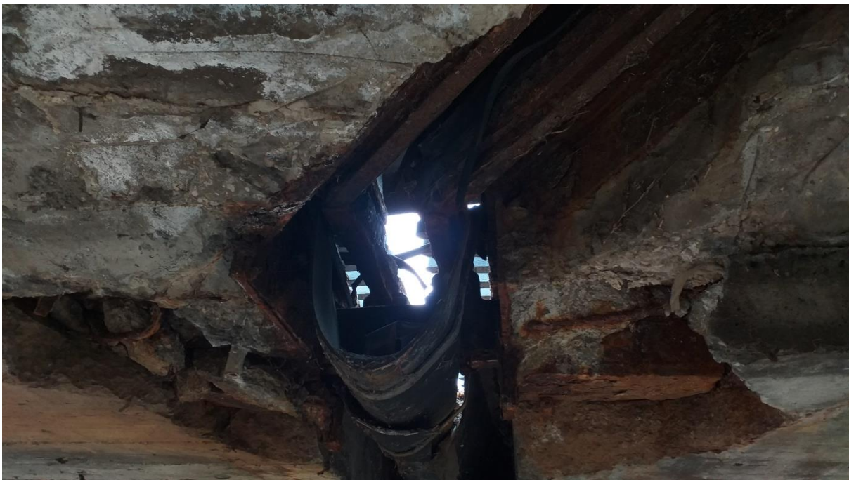
ISTOČNI MOST - stol S6 (S18): otvorena dilatacijska naprava
