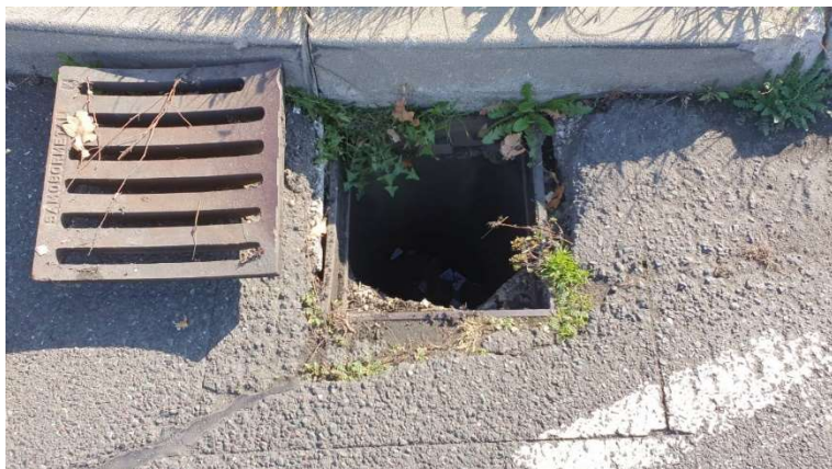
Fotografija 2: Oštećenja na slivniku 2
