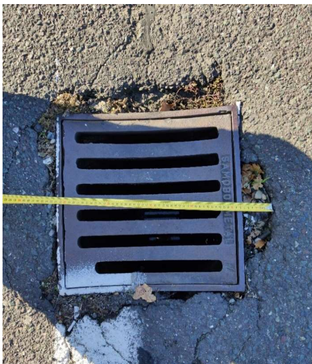
Fotografija 1: Oštećenja na slivniku 1
