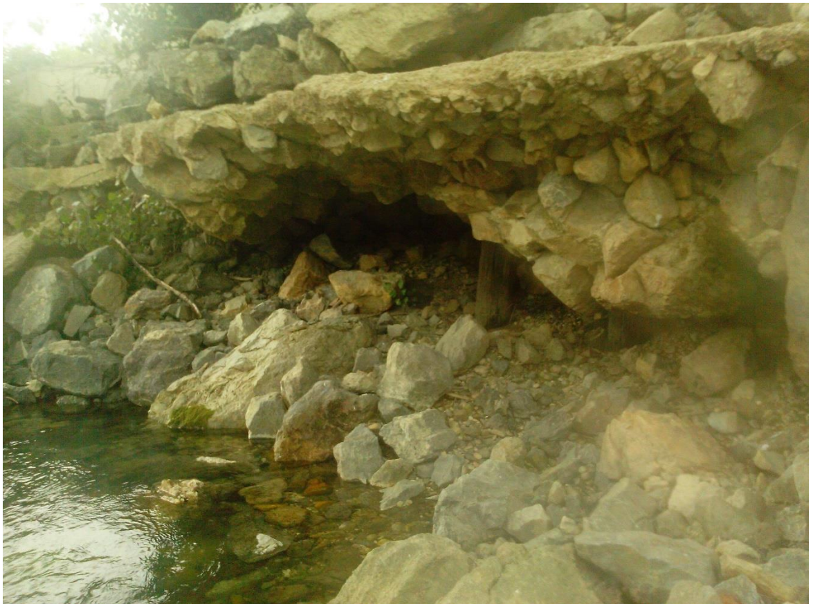
Slika 6 Urušena zaštita od kamenog nabačaja stupova S15 na sjevernom pokosu
