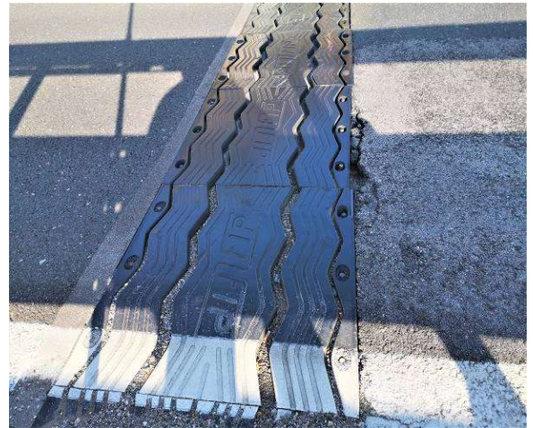
OŠTEĆENJE ASFATA I NAPRAVE
