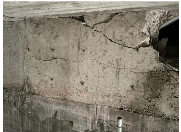
Slika 1.3-8 Pukotine u betonu oko otvora
