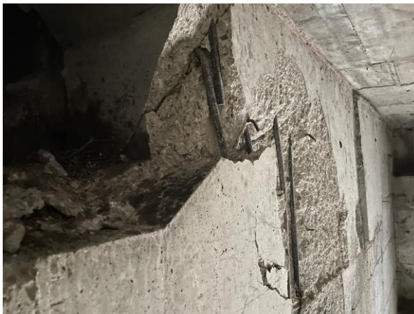
Slika 1.3-7 Odlamanje betona oko otvora
