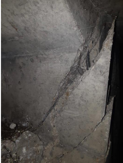
Slika 1.3-5 Odlamanje betona oko otvora
