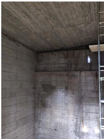
Slika 1.3-11 Vidljive zone odvajanje i otpadanja betona zaštitnog sloja armature u pogledu prijelazne ploče
