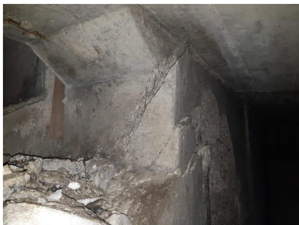
Slika 1.3-3 Odlamanje betona oko otvora
