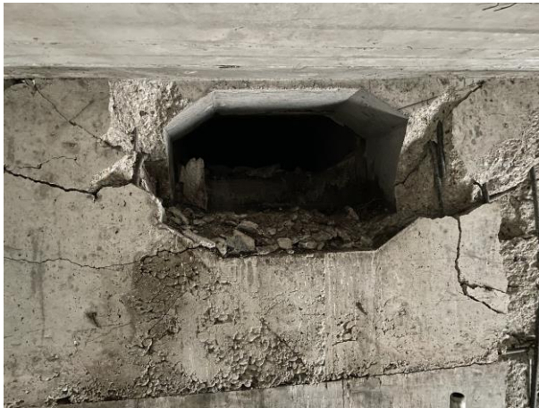
Slika 1.3-9 Raspucani beton oko otvora
