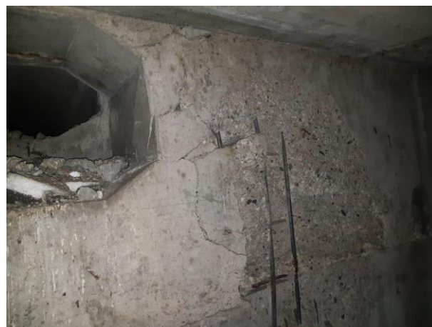
Slika 1.3-4 Odlamanje zaštitnog sloja betona te korozija armature oko otvora
