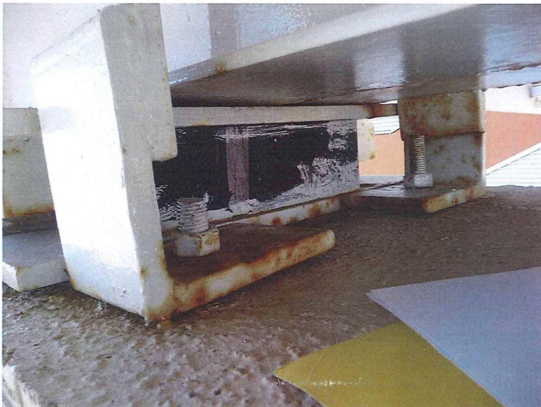
Sl 3. Ležaj na stupu br. 5 : smjer ST
