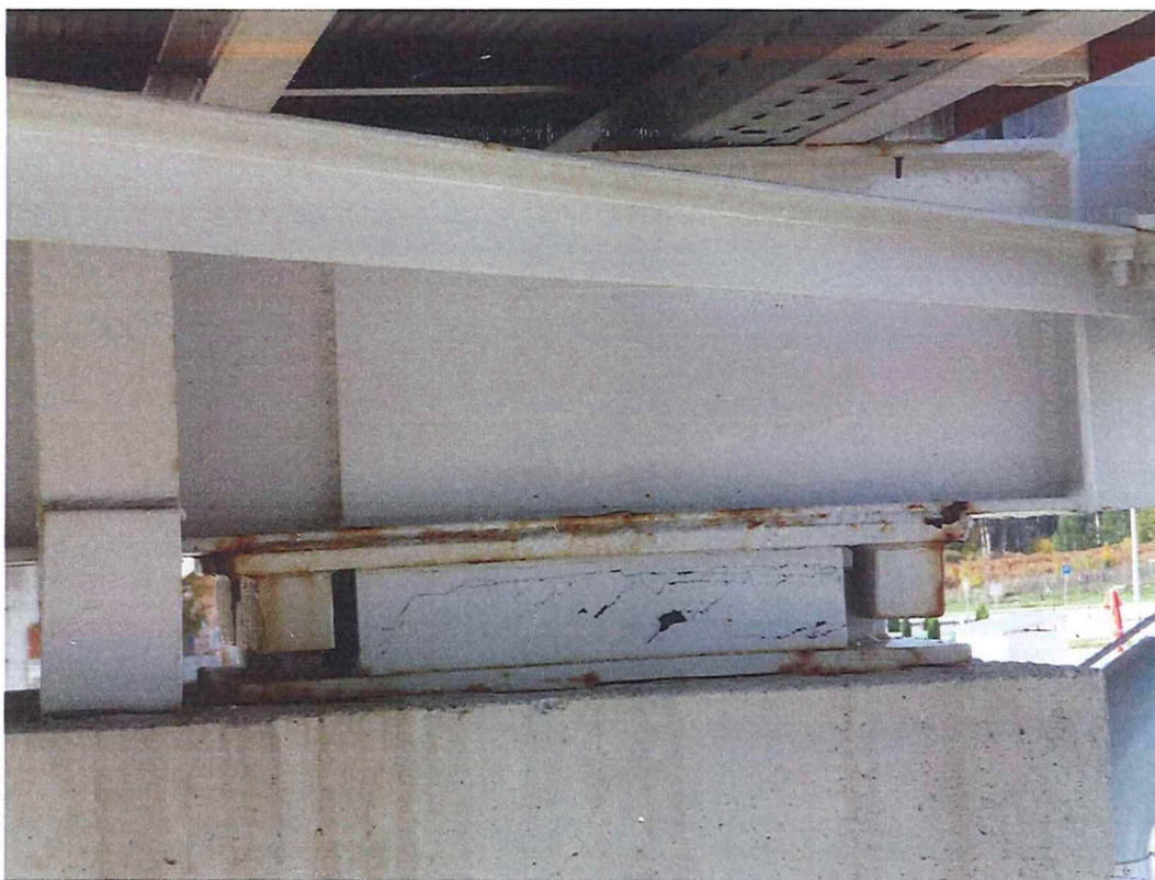
Sl 4. Ležaj na stupu br. 4 : smjer ZG
