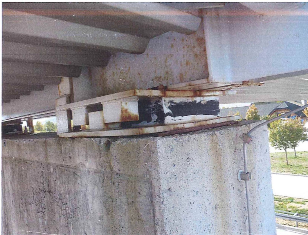
Sl 6. Ležaj na stupu br. 3 : smjer ZG
