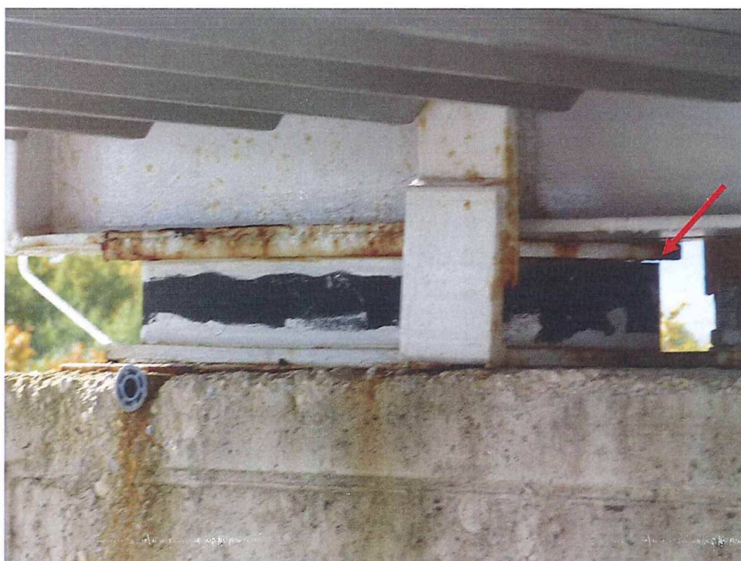
Sl 7. Ležaj na stupu br. 3 : smjer ST
