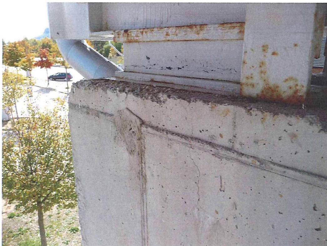
Sl 9. Ležaj na stupu br. 2 : smjer ST
