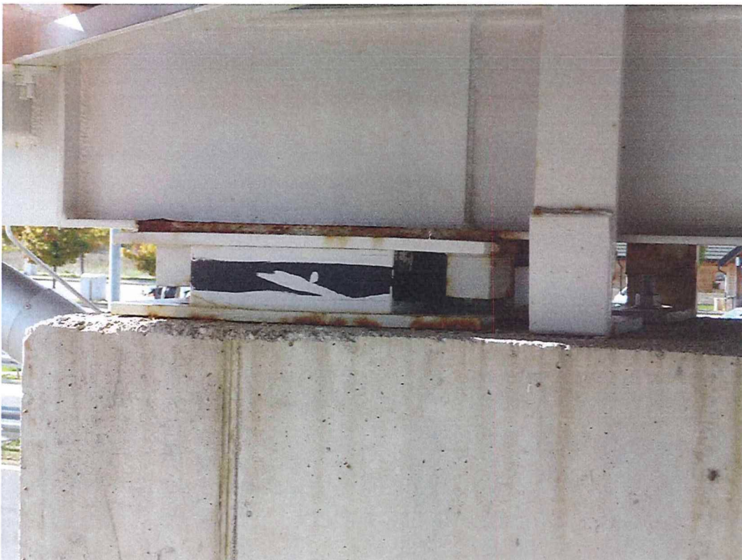
Sl 5. Ležaj na stupu br. 4 : smjer ST
