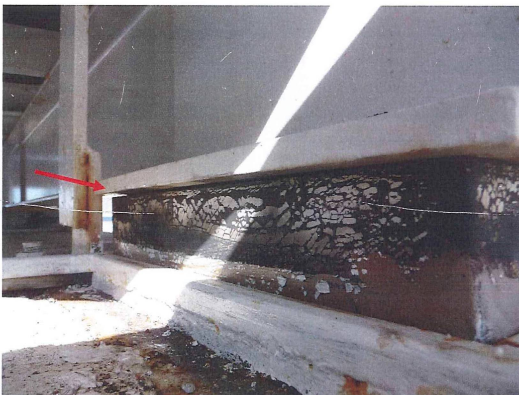
Sl 13 ležaj na stupu br. 1, ST - sanirani ležaj: ležaj s jedne strane ima visinu 80 mm, a na drugoj je odvojen od gornje ploče (visina za cca 2-3 mm veća od 85 mm, koliko je visina u neopterećenom stanju). Dakle, na širini od 30 cm, razlika u svijetlom otvoru gornje i donje čelične ploče iznosi cca 8 mm.
