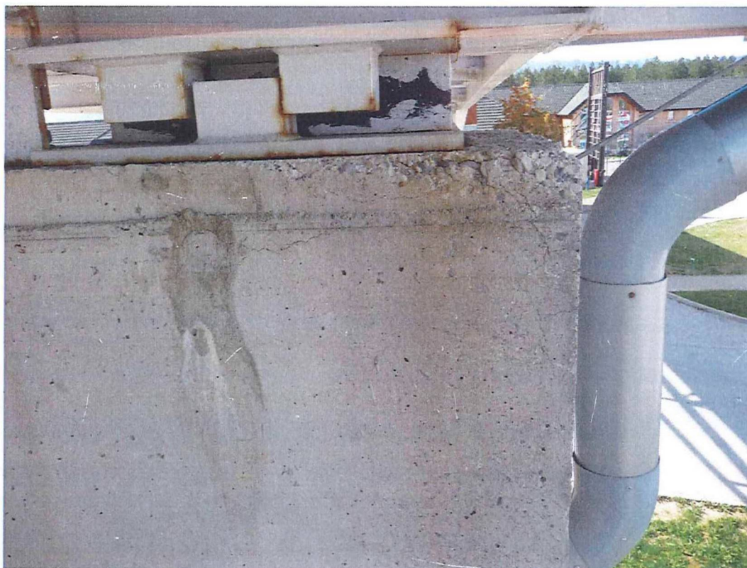
Sl 8. Ležaj na stupu br. 2 : smjer ZG
