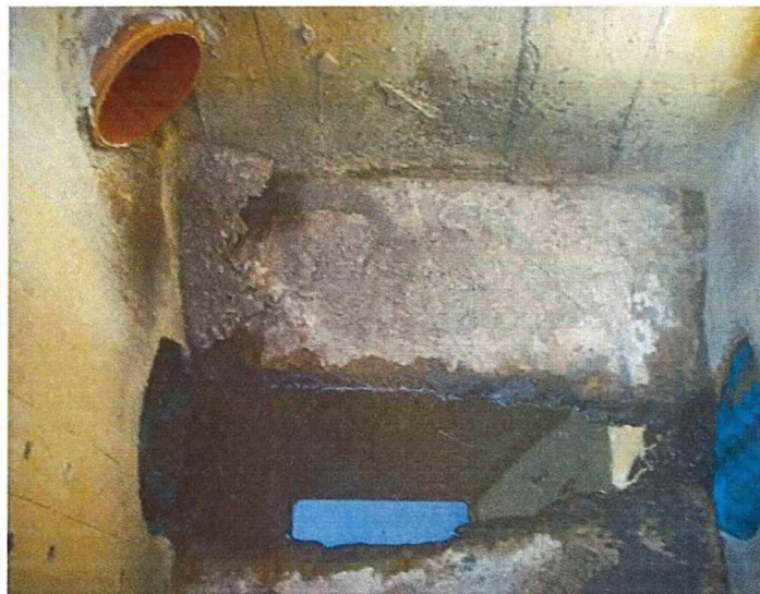
Slika 5 – Fotografija okna u km 121+200 (lijevo)
