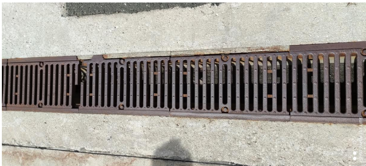
Slika 2. oštećenje okvira rešetke i oštećene rešetke
