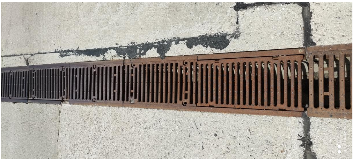
Slika 5. oštećenje okvira rešetke, neadekvatna zamjenska rešetka i nedostatak pričvrsnih vijaka
