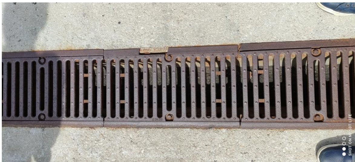
Slika 1. oštećenje okvira rešetke
