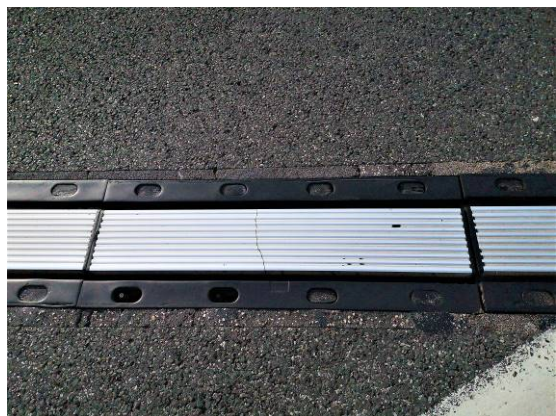
PUKNUĆE SEGMENTA ZAPADNE NAPRAVE
