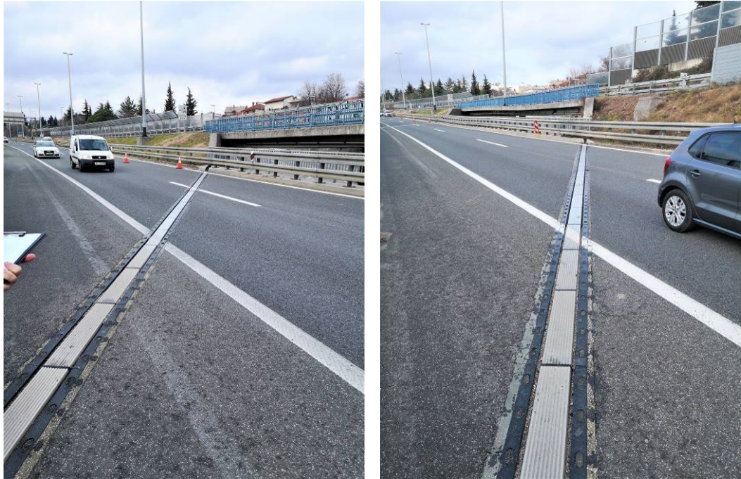
POGLED NA ZAPADNU I ISTOČNU PRIJELAZNU NAPRAVU
