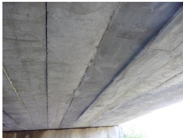
Slika 1.15 Vidljivi progibi nosača
