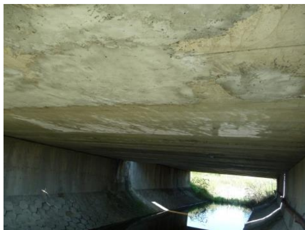
Slika 1.10 Prethodno sanirani dio mosta
