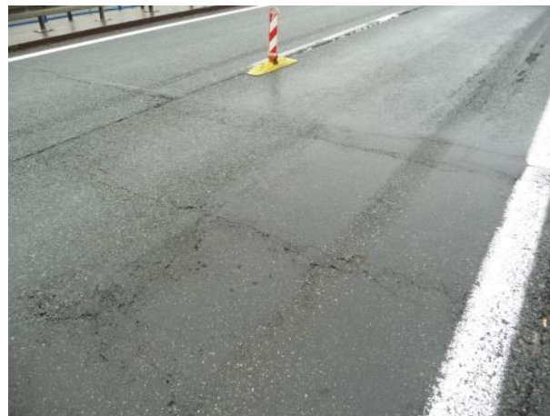
Slika 1.9 Poprečna oštećenja kolničke konstrukcije
