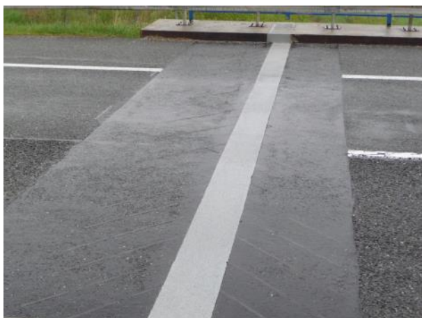
Slika 1.4 Sanirana prijelazna naprava desnog objekta
