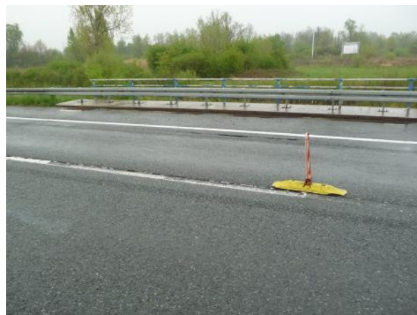
Slika 1.7 Pukotine na lijevom objektu
