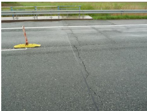
Slika 1.6 Pukotine na lijevom objektu
