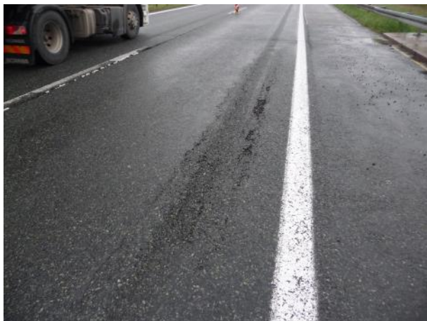
Slika 1.8 Uzdužna oštećenja kolničke konstrukcije
