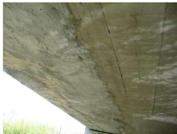
Slika 1.11 Prethodno sanirani dio mosta
