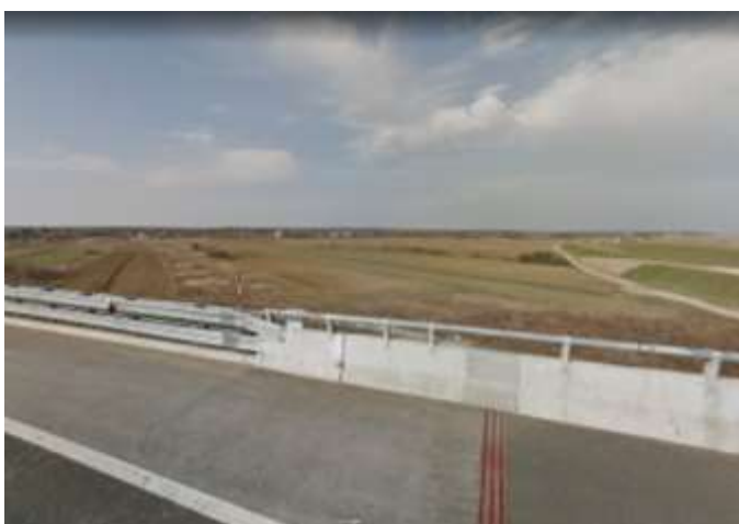
Slika 1: opšavni lim betonske ograde na dilataciji uz zaustavnu traku
