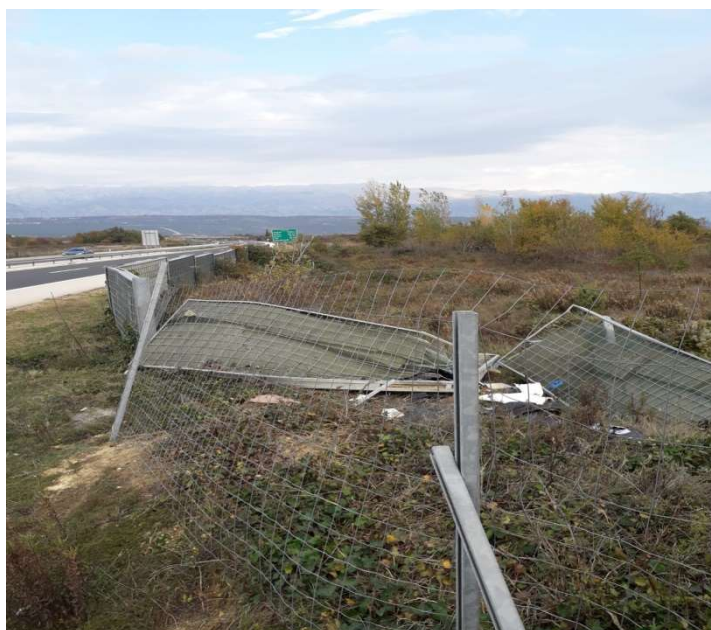
Slika 3. Prikaz oštećenog dijela zida za zaštitu od buke u zoni 252+800 na autocesti A1
