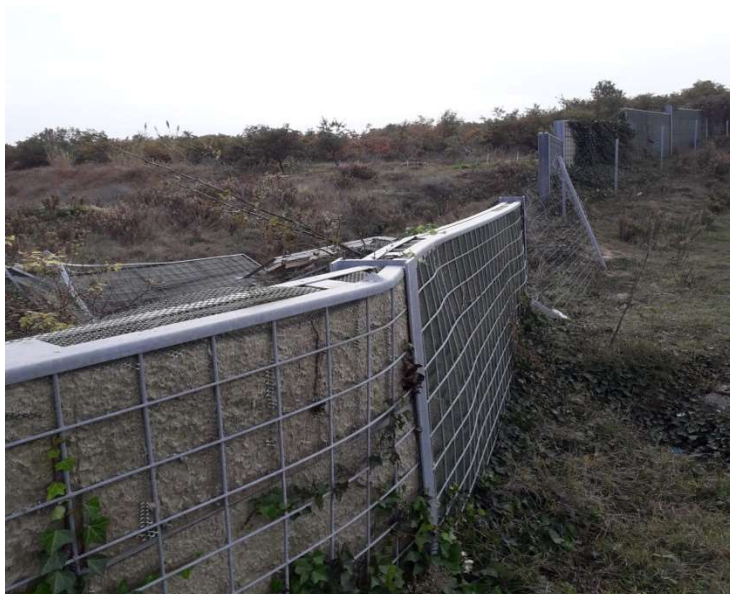
Slika 2. Prikaz oštećenog dijela zida za zaštitu od buke u zoni 252+800 na autocesti A1
