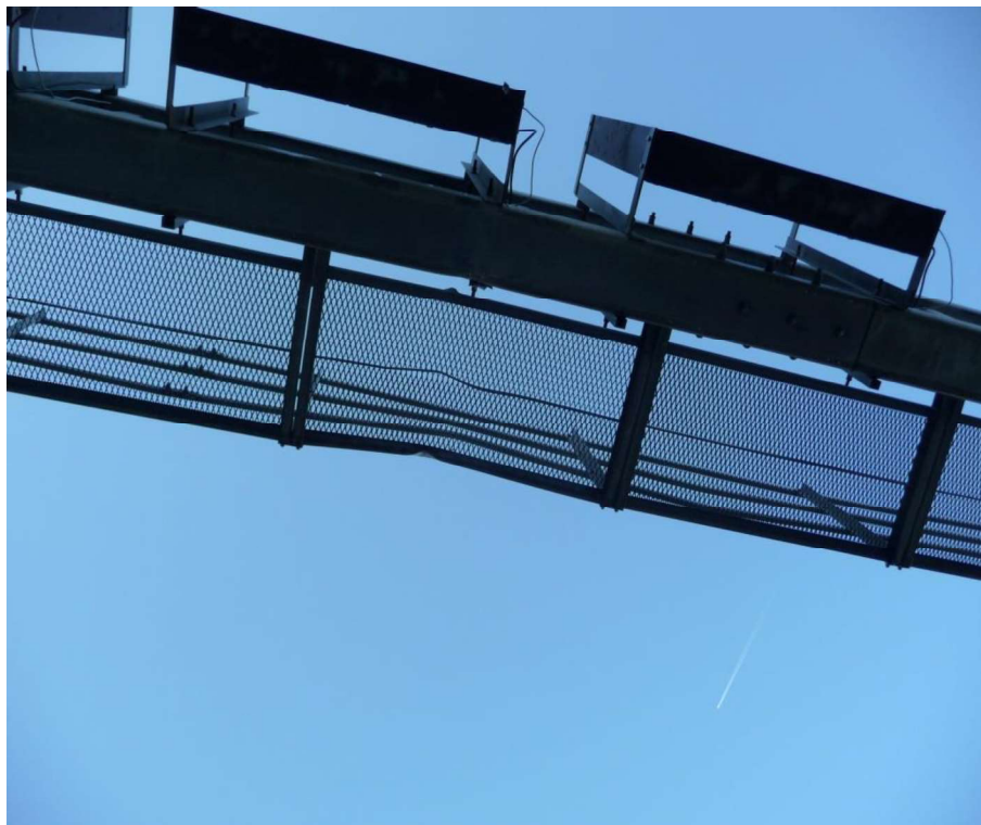
Slika 3. Prikaz oštećenog dijela portala.
