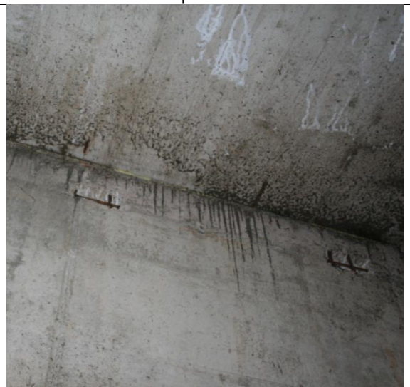
Pregled uočenih oštećenja bočnih zidova i
