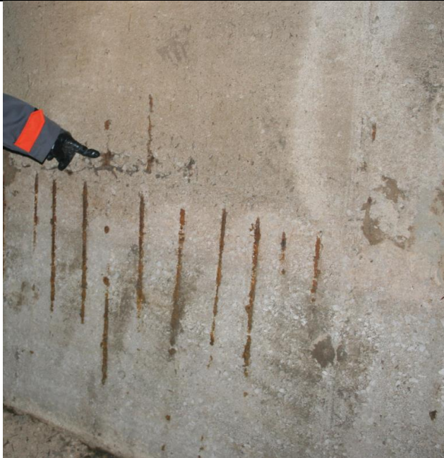
Pregled uočenih oštećenja bočnih zidova separatora
