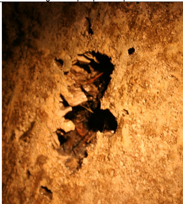
Pregled oštećenja zidova
