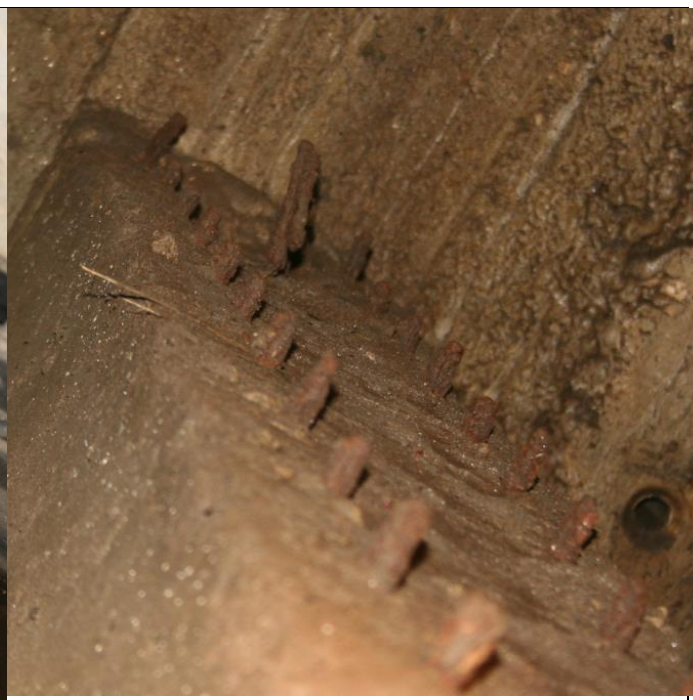
Pregled oštećenja izlaznog izljevnog zida
