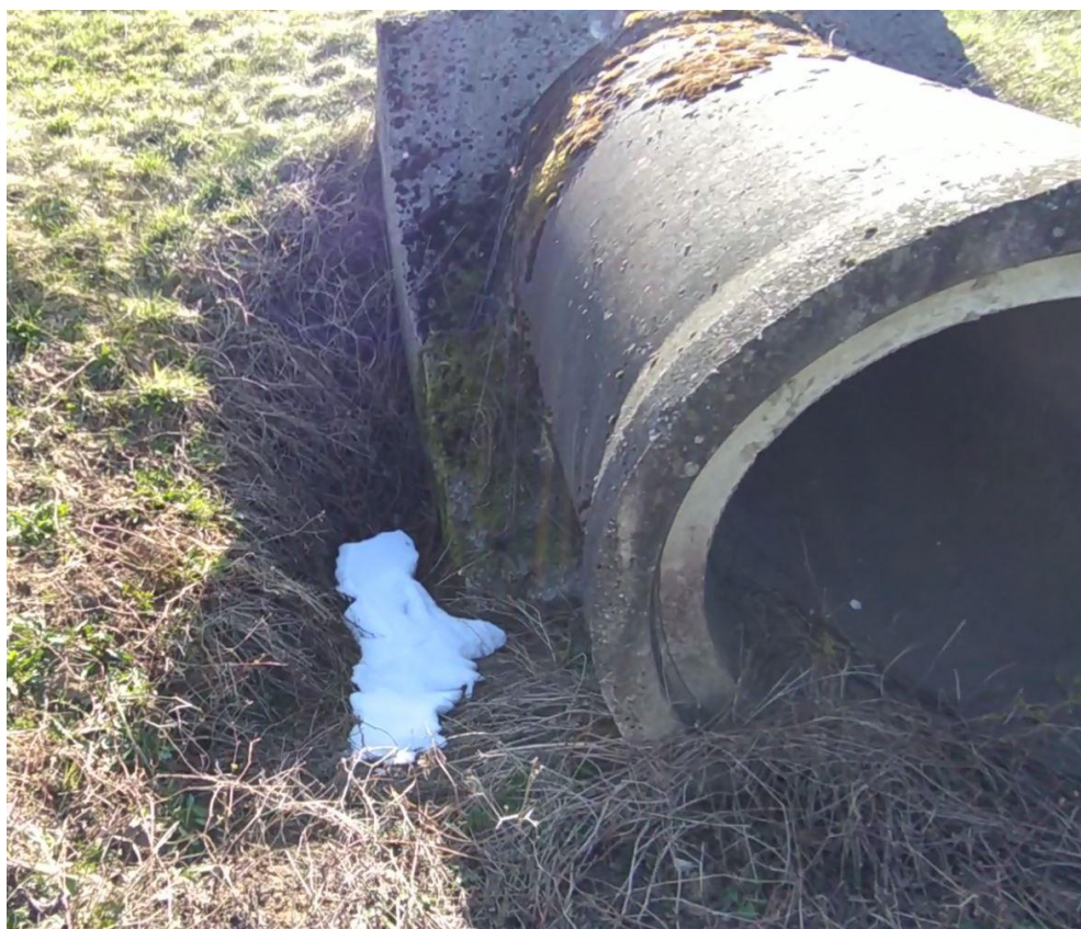
Slika 6. Izlazna cijev i betonski blok – isprano tlo, slijeganje i rotacija cijevi
