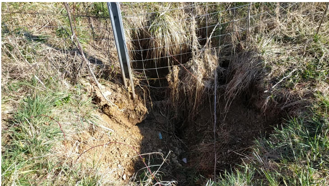
Slika 9. Ispiranje tla ispod temelja stupa žičane ograde (kaverna)
