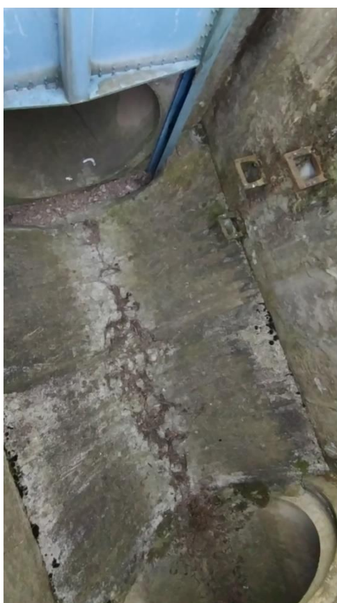
Slika 8. Zasunsko okno na izlazu iz lagune – pogled iznutra: stanje funkcionalno
