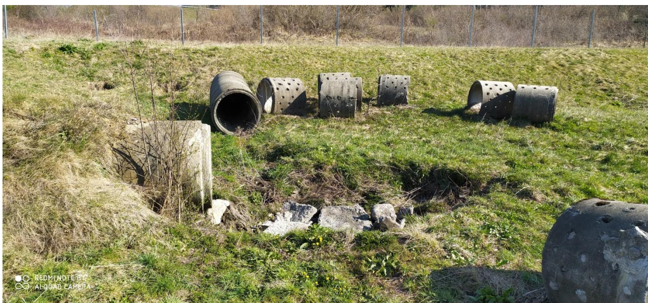
Slika 3. Isprano tlo i betonska podloga nakon AB ulazne cijevi s dislociranim disipatorima energije
