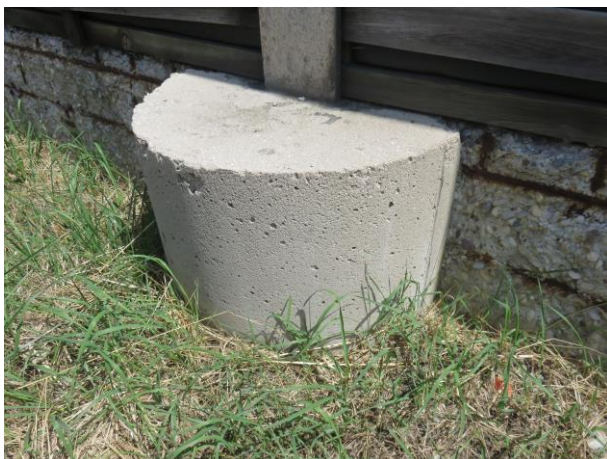
Slika Pogreška! Za dodavanje Heading 2;Heading 2 H2 tekstu koji želite da se ovdje pojavi koristite karticu Polazno.-1: Zid u km 140 – tipično stanje, dobar beton temelja stupa, loš beton temeljne trake
