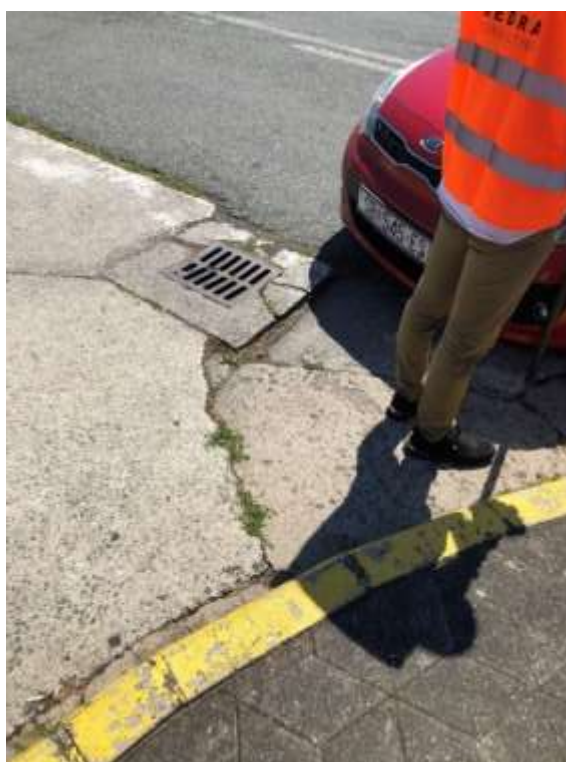
Slika 3: Zatečeno stanje slivnika
