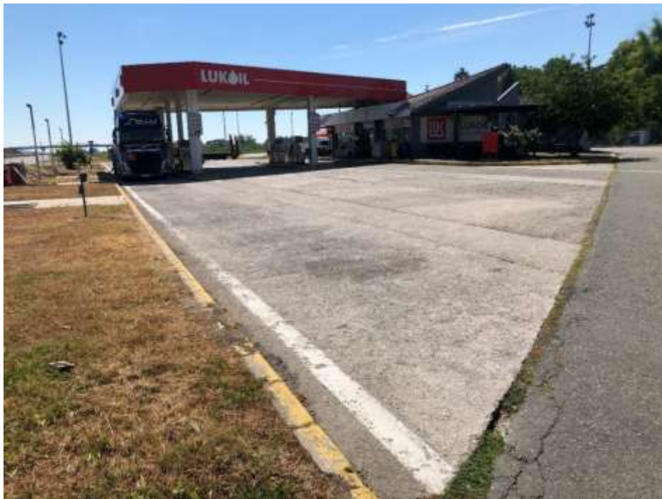
Slika 4: Reška na spoju betonske i asfaltne konstrukcije
