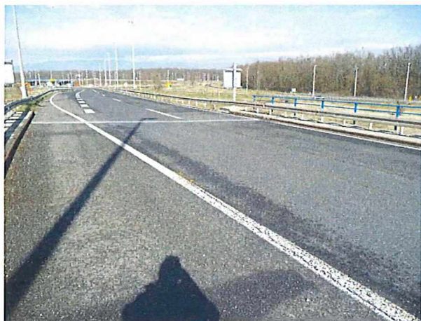
Prijelazna naprava – strana Zg
