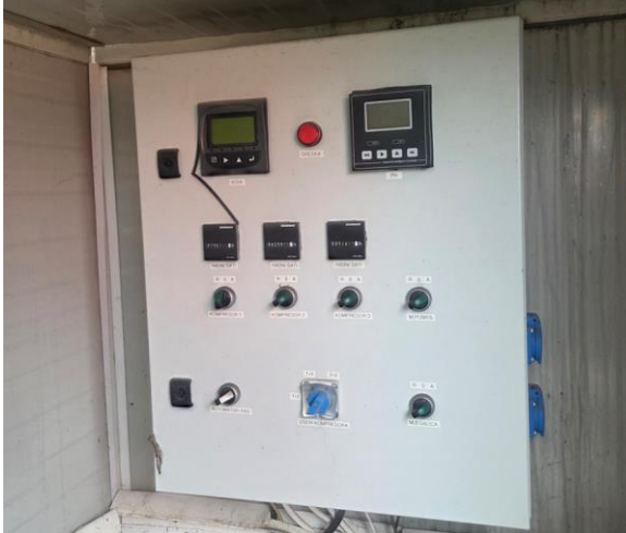
Slika 3.5. Upravljački ormar (nije u funkciji - ugašen)
