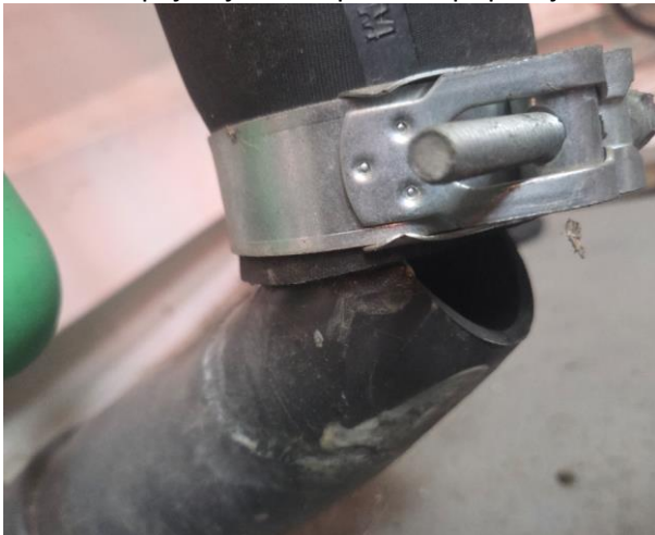
Slika 3.7. Spojni cjevovod puhalo s pripadajućom obujmicom (otpojeno)
