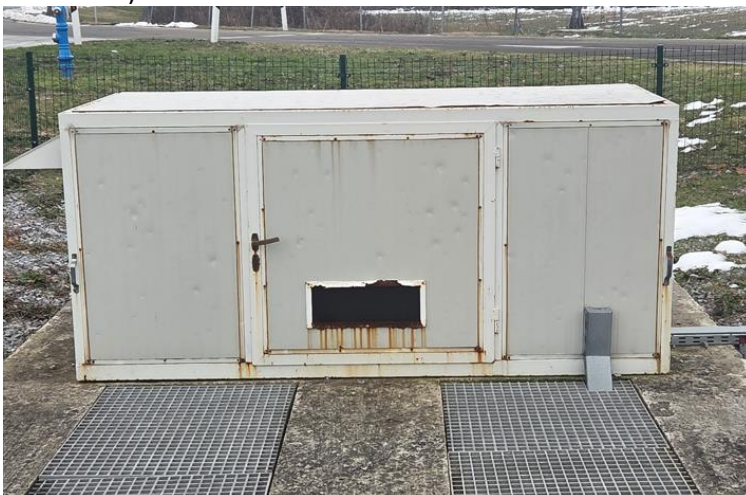
Slika 3.9. Kontejner za smještaj opreme UPOV-a (dotrajala rešetka za usis zraka, potreban je servis šarki vrata)
