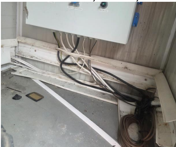
Slika 3.10. Elektroinstalacije unutar objekta UPOV-a (potrebna sanacija)
