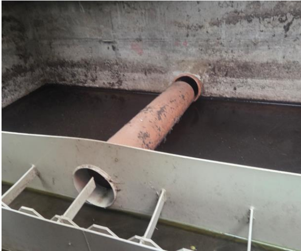
Slika 3.8. Ispust pročišćene vode
