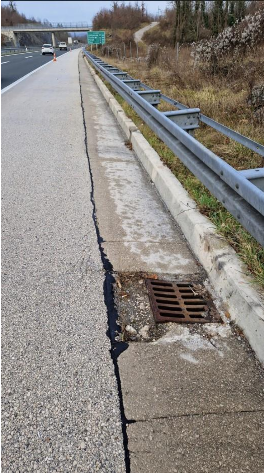
Slika 4. Postojeći oštećeni slivnik s jednom rešetkom
