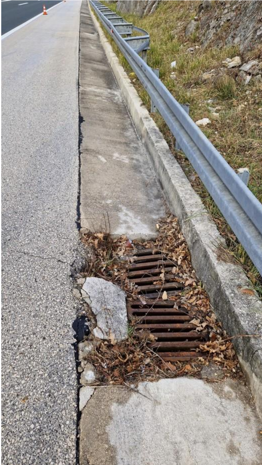
Slika 5. Postojeći oštećeni slivnik s dvije rešetke
