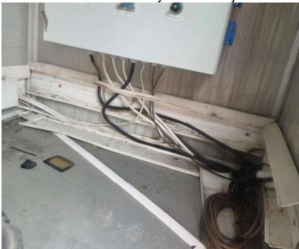
Slika 3.10. Elektroinstalacije unutar objekta UPOV-a (potrebna sanacija)
