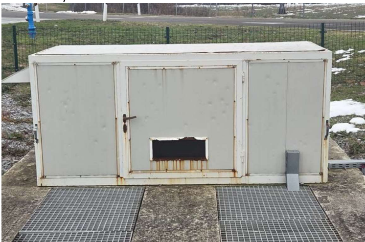
Slika 3.9. Kontejner za smještaj opreme UPOV-a (dotrajala rešetka za usis zraka, potreban je servis šarki vrata)
