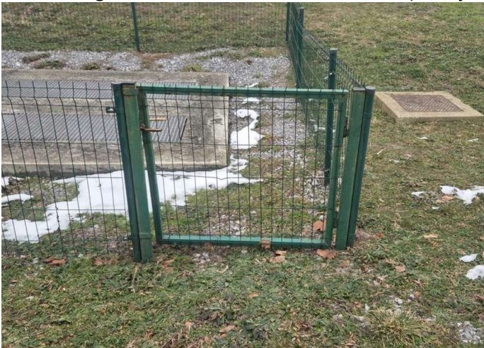
Slika 3.3. Ograda oko UPOV-a s ulaznim vratima (dotraja ograda i ulazna vrata)
