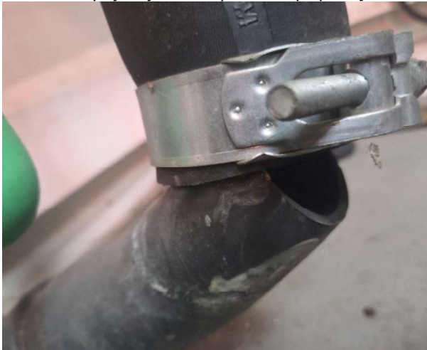
Slika 3.7. Spojni cjevovod puhala s pripadajućom obujmicom (otpojeno)
