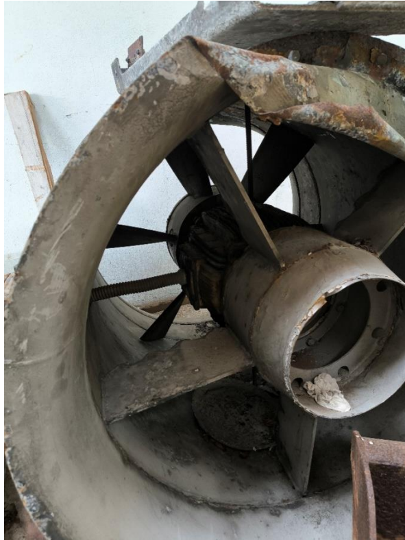
Slika 3. Oštećeni ventilator kojeg je potrebno zamijeniti – prednja strana
