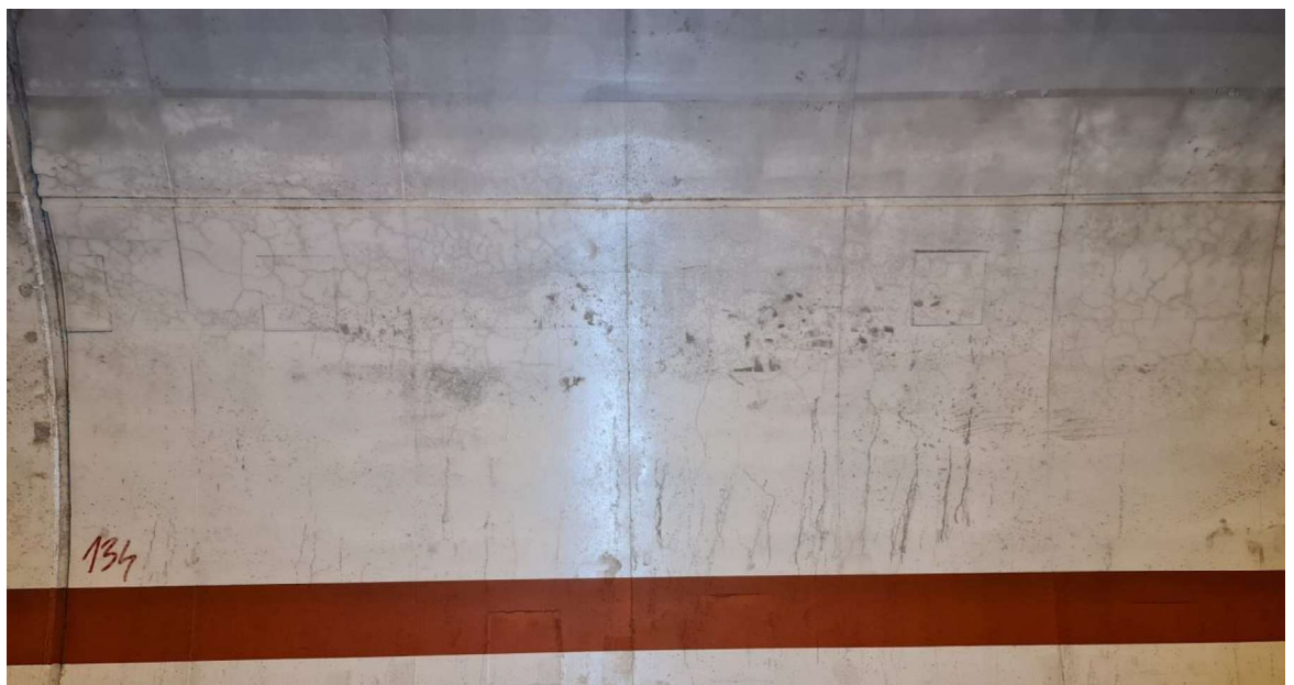
Slika 17: Kampada 134 - MREŽASTE PUKOTINE
