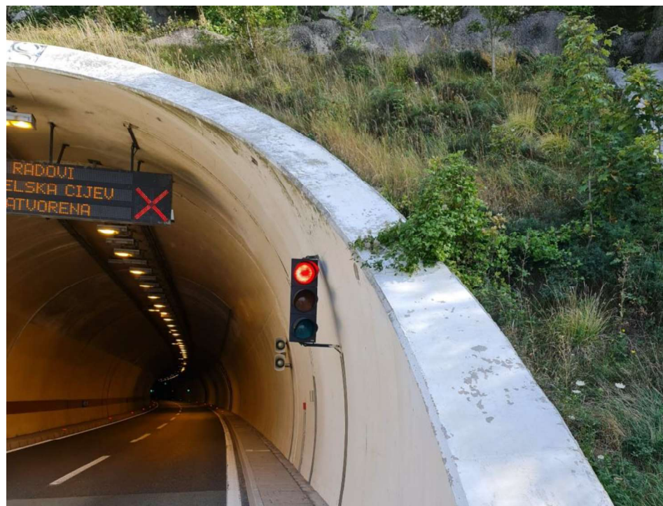
Slika 2: Ulazni portal - LJUŠTENJE PREMAZA BETONA
