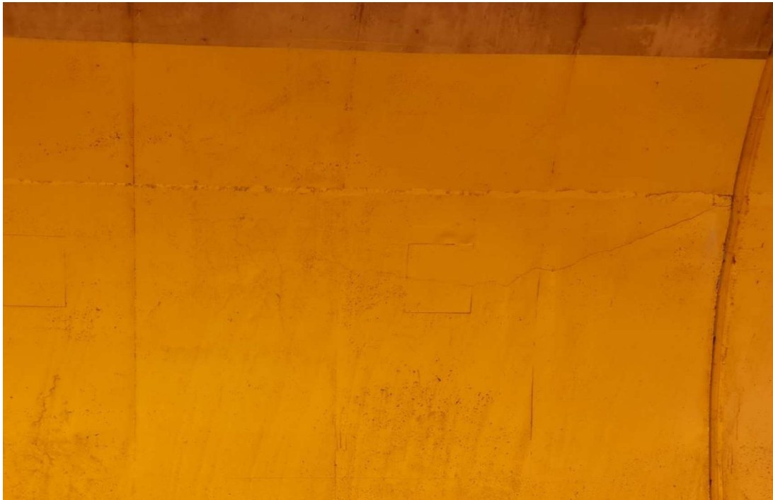
Slika 9: Kampada 180 - UZDUŽNA PUKOTINA BOKA
