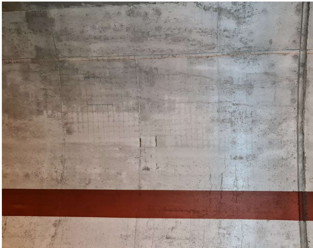
Slika 24: Kampada 86 - SEGREGACIJA, KOROZIJA ARMATURE I NEDOSTATAK ZAŠTITNOG SLOJA
