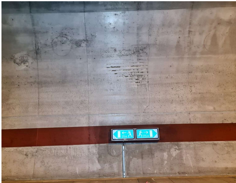
Slika 29: Kampada 35 - RADIJALNA PUKOTINA, KOROZIJA ARMATURE
