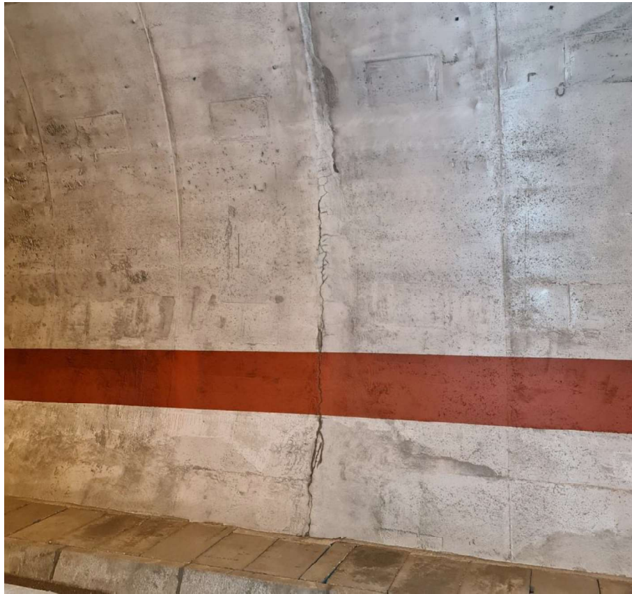
Slika 26: Kampada 39 - RADIJALNA/ MREŽASTA PUKOTINA SPOJNICE SA VLAŽENJEM
