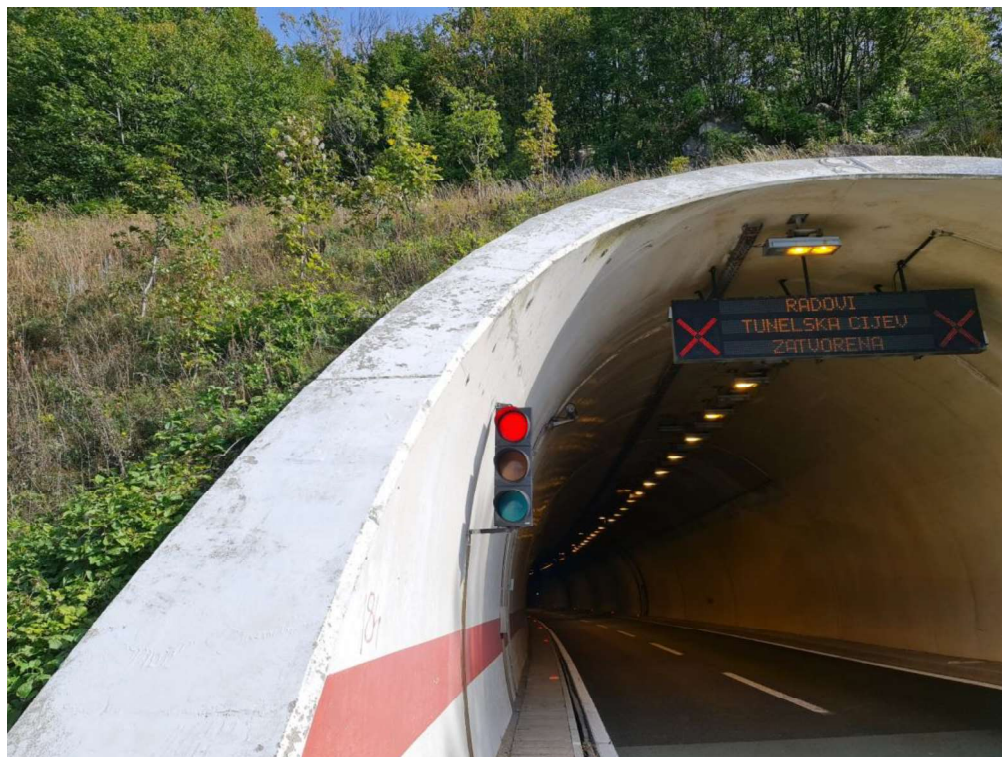
Slika 1: Ulazni portal - LJUŠTENJE PREMAZA BETONA
