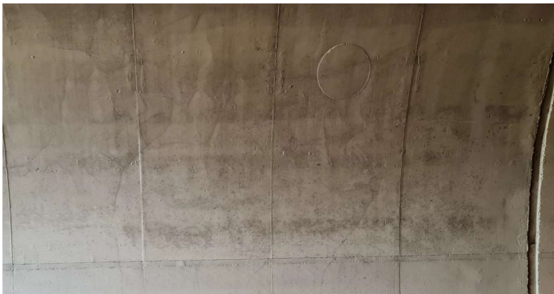
Slika 33: Kampada 2 - MREŽASTE PUKOTINE
