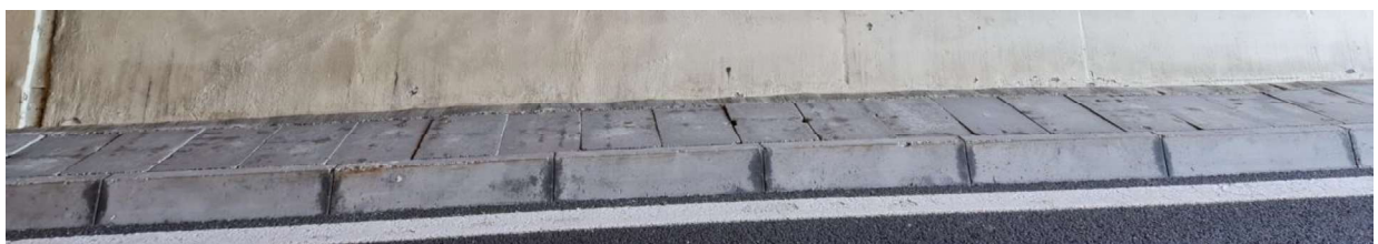
Slika 34: Kampada 2 - KOROZIJA ARMATURE AB PLOČA HODNIKA
