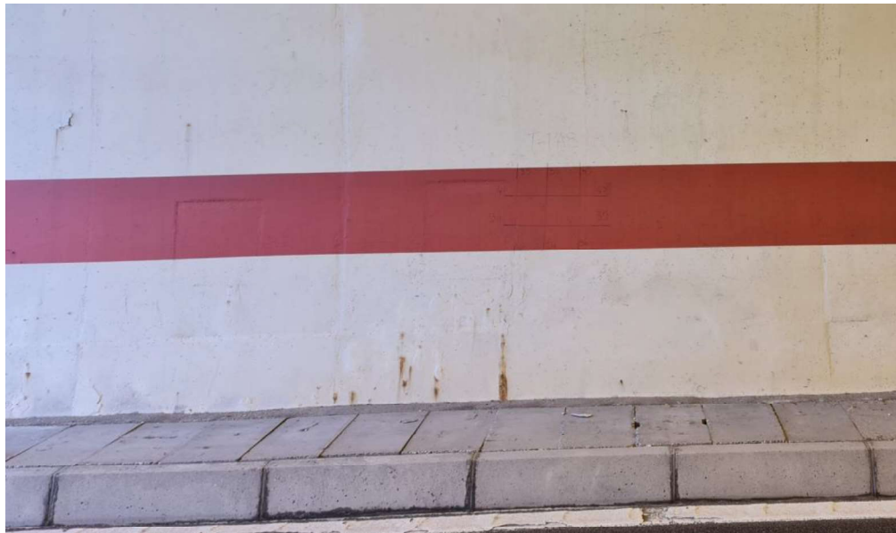
Slika 4: Kampada 183 - MRLJE OD KOROZIJE ARMATURE
