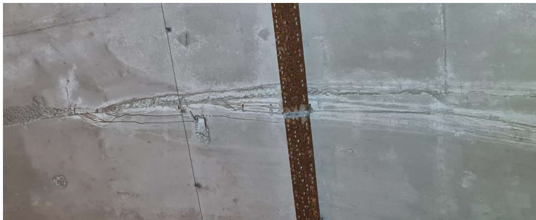
Slika 13: Kampada 148 - PUKOTINA SA IZLUŽIVANJEM
