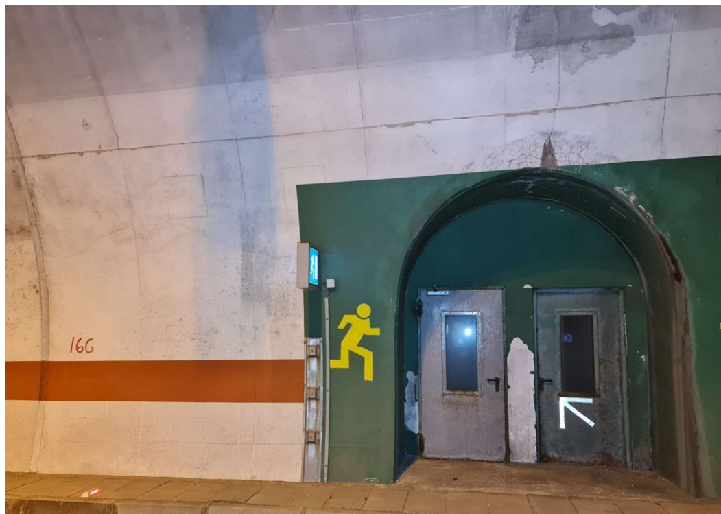
Slika 10: Kampada 166 - UZDUŽNE, RADIJALNE I DIJAGONALNE PUKOTINE, LJUŠTENJE PREMAZA I IZLUŽIVANJE
