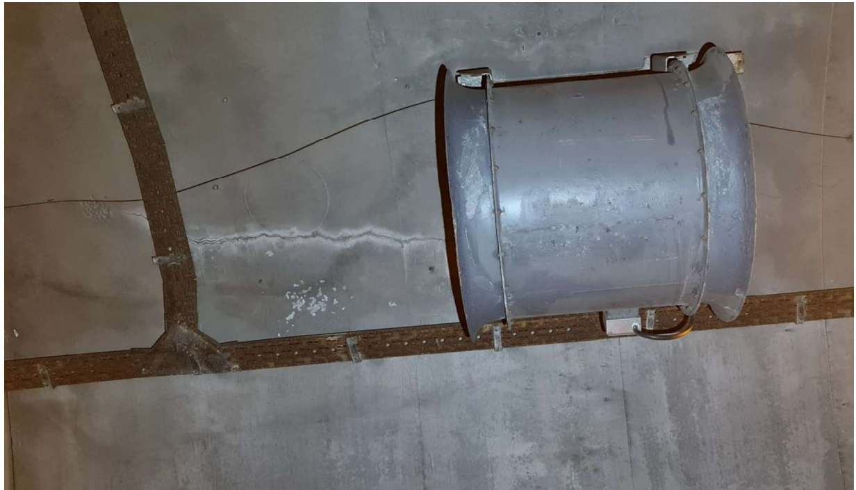
Slika 30: Kampada 35 - UZDUŽNA PUKOTINA, IZLUŽIVANJE
