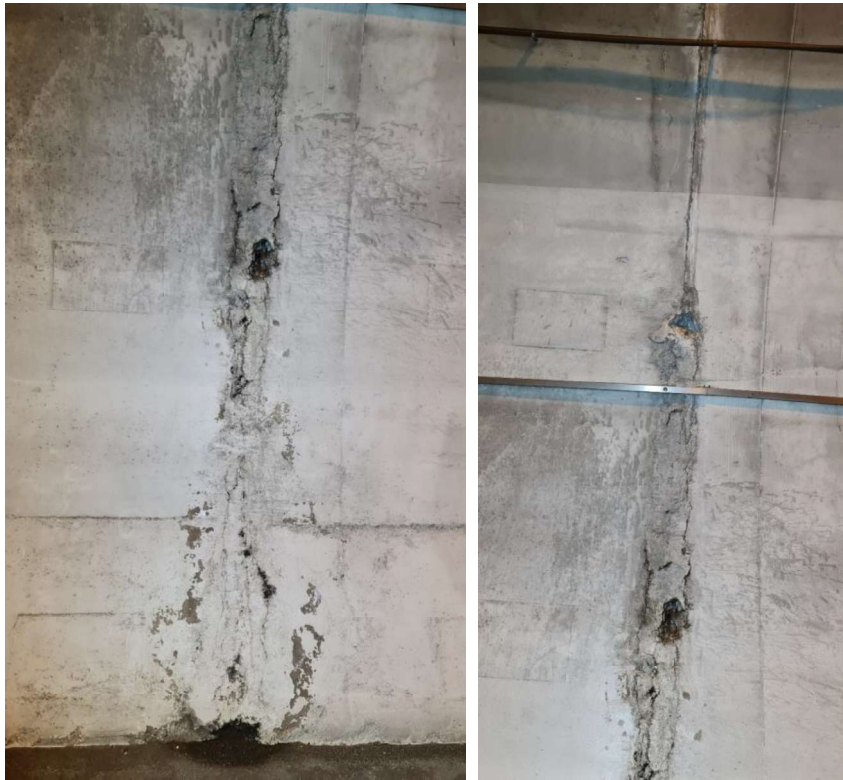
Slika 22: Kampada 91 - PUKOTINE, VLAŽENJE I LJUŠTENJE SANIRANE SPOJNICE
