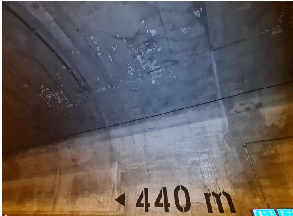
Slika 28: Kampada 38 - LJUŠTENJE POVRŠINE BETONA I SEGREGACIJA, KOROZIJA ARMATURE
