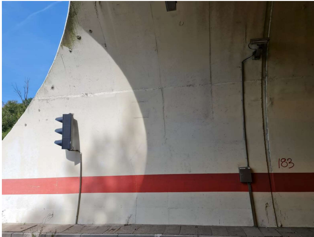
Slika 3: Ulazni portal - LJUŠTENJE PREMAZA BETONA I RADIJALNA PUKOTINA
