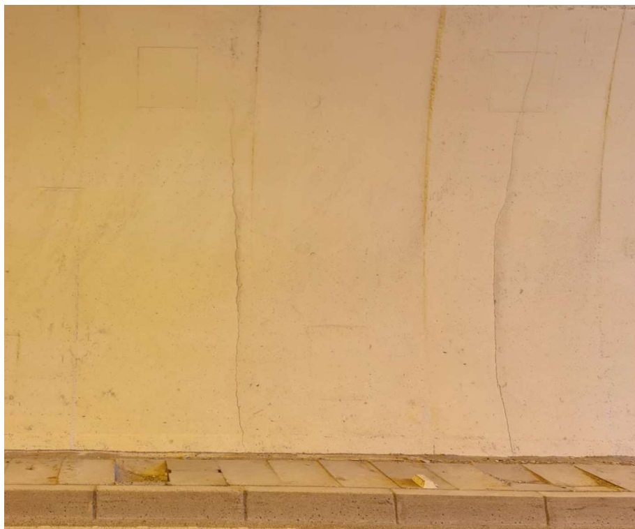
Slika 6: Kampada 181 - RADIJALNE PUKOTINE
