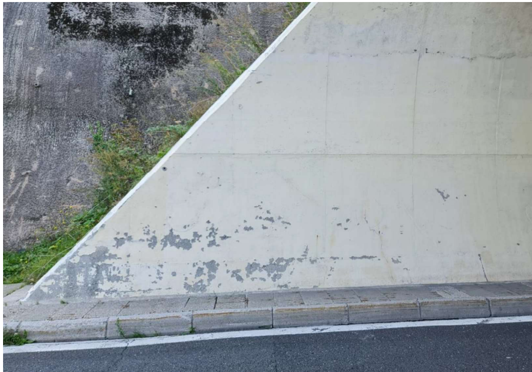
Slika 36: ulazni portal - LJUŠTENJE PREMAZA, KOROZIJA I LJUŠTENJE AB PLOČA HODNIKA
