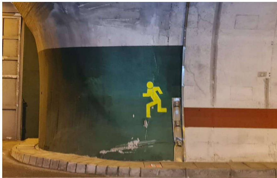
Slika 21: Kampada 91 - RADIJALNA PUKOTINA, MEHANIČKO OŠTEĆENJE OBLOGE
