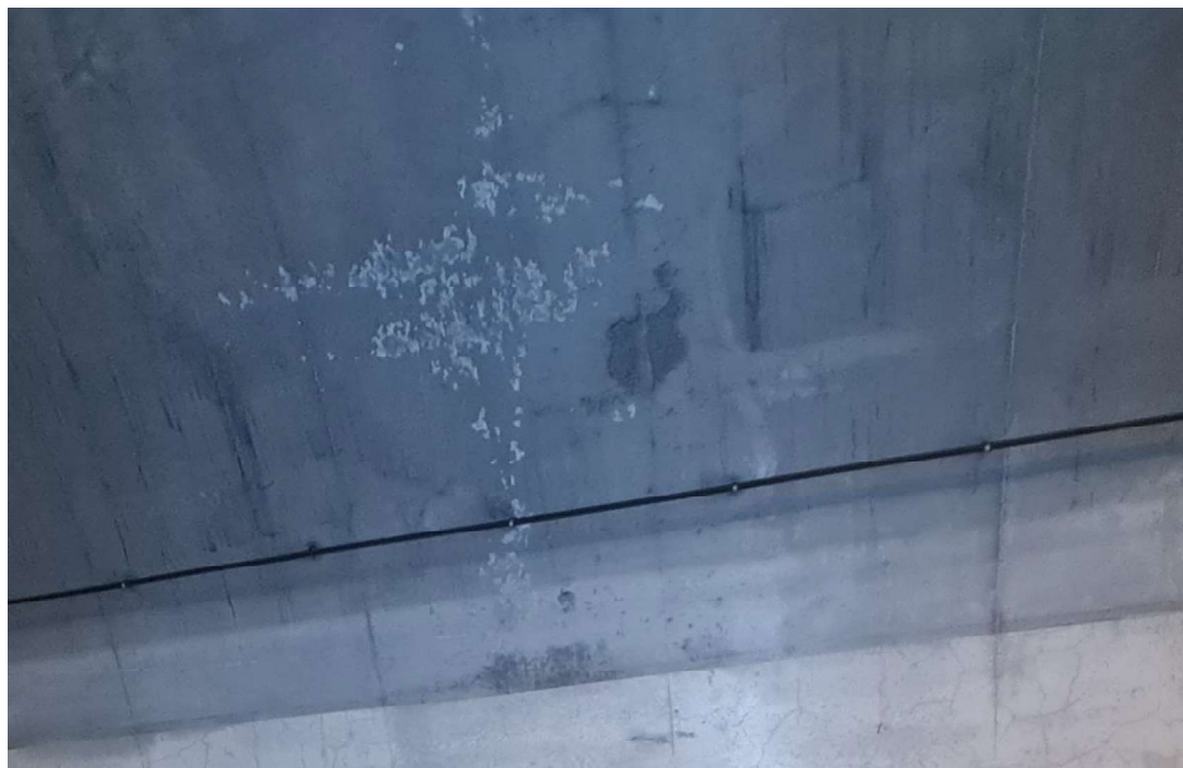
Slika 18: Kampada 127 - LJUŠTENJE POVRŠINE BETONA
