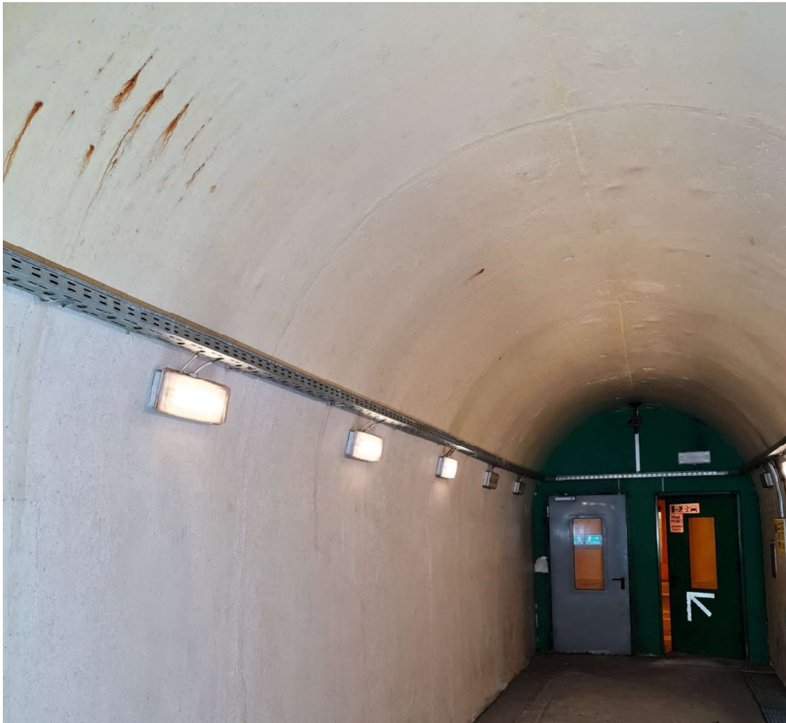
Slika 11: Pješački prolaz - KOROZIJA ARMATURE, NEDOSTATAK ZAŠTITNOG SLOJA
