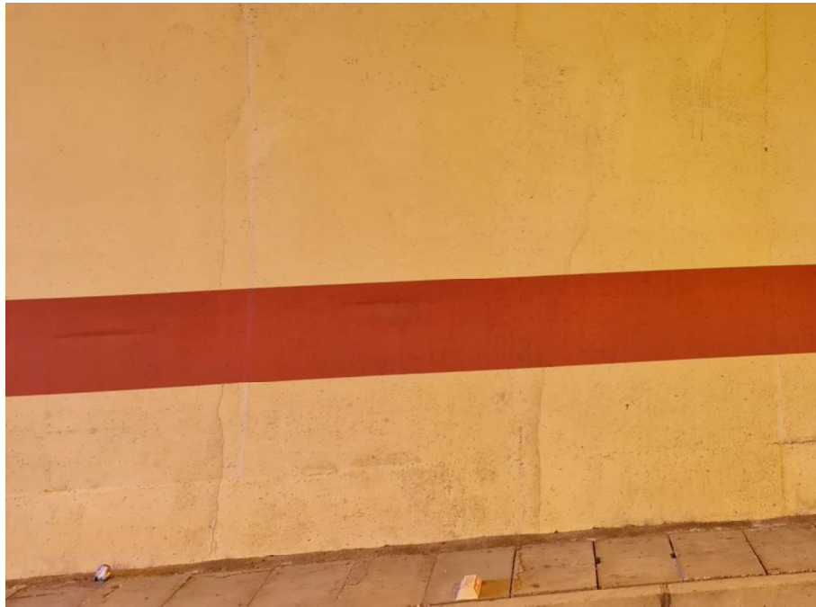
Slika 5: Kampada 182 - RADIJALNE PUKOTINE
