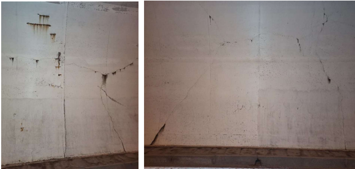
Slika 19: Kampada 35 - PUKOTINE I ARMATURA
