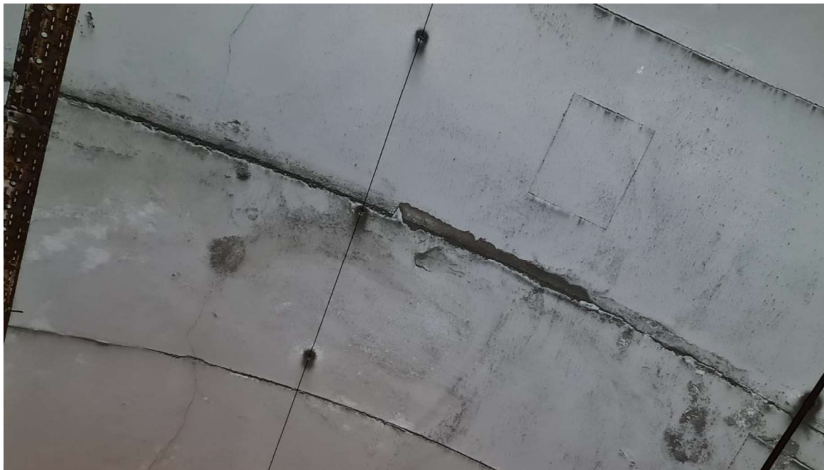
Slika 58: Kampada 167-168 - PUKOTINA, ODLAMANJE BETONA
