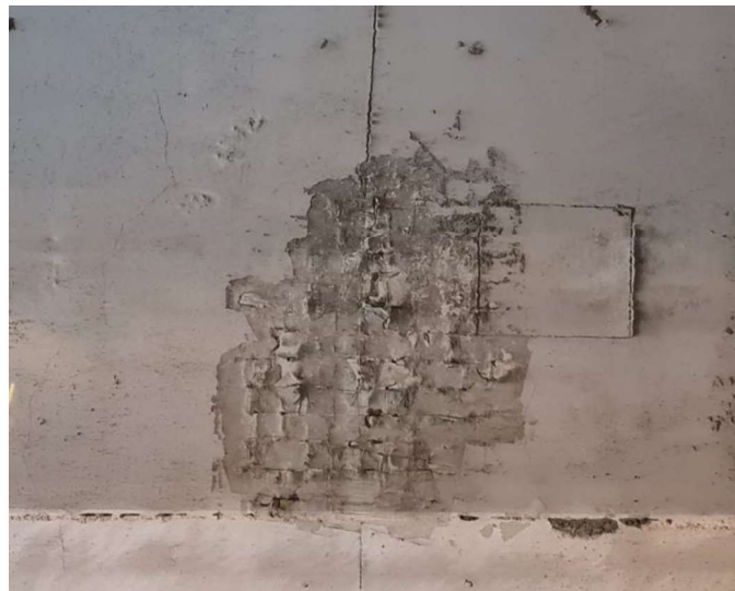
Slika 56: Kampada 164 - ARMATURA BEZ ZAŠTITNOG SLOJA I LJUŠTENJE BETONA
