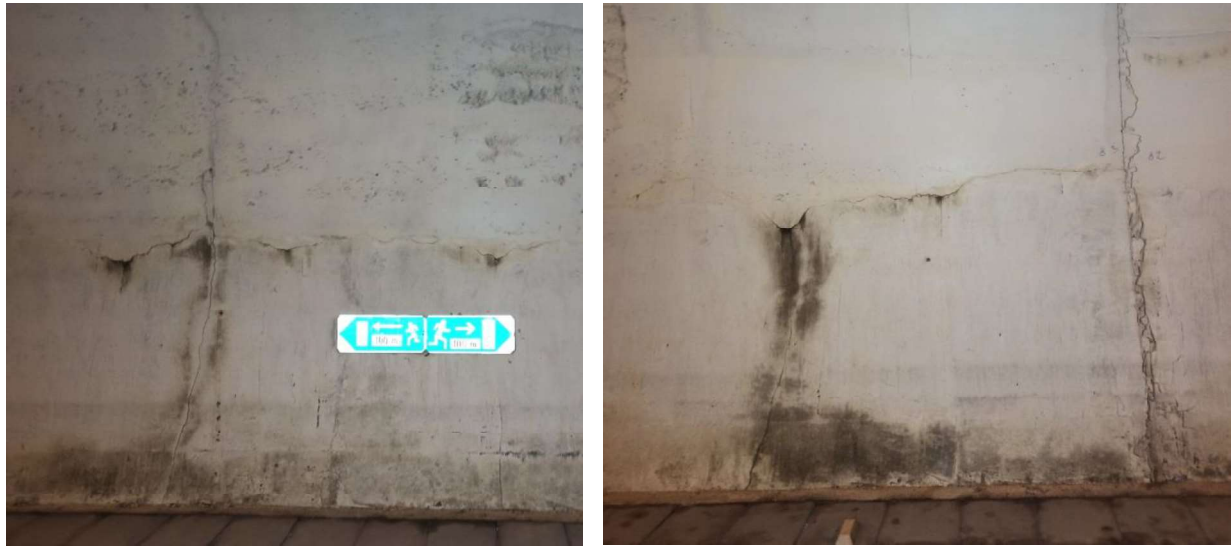
Slika 35: Kampada 83 - PUKOTINE, IZLUŽIVANJE
