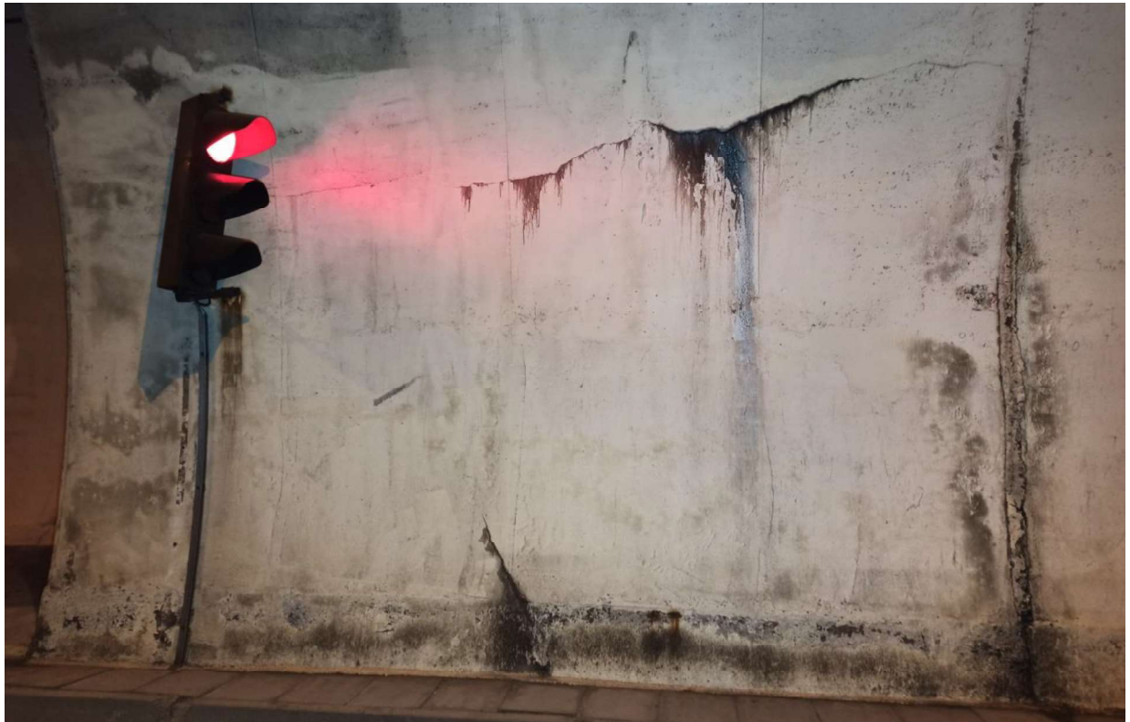
Slika 37: Kampada 91 - PUKOTINA, VLAŽENJE/ IZLUŽIVANJE
