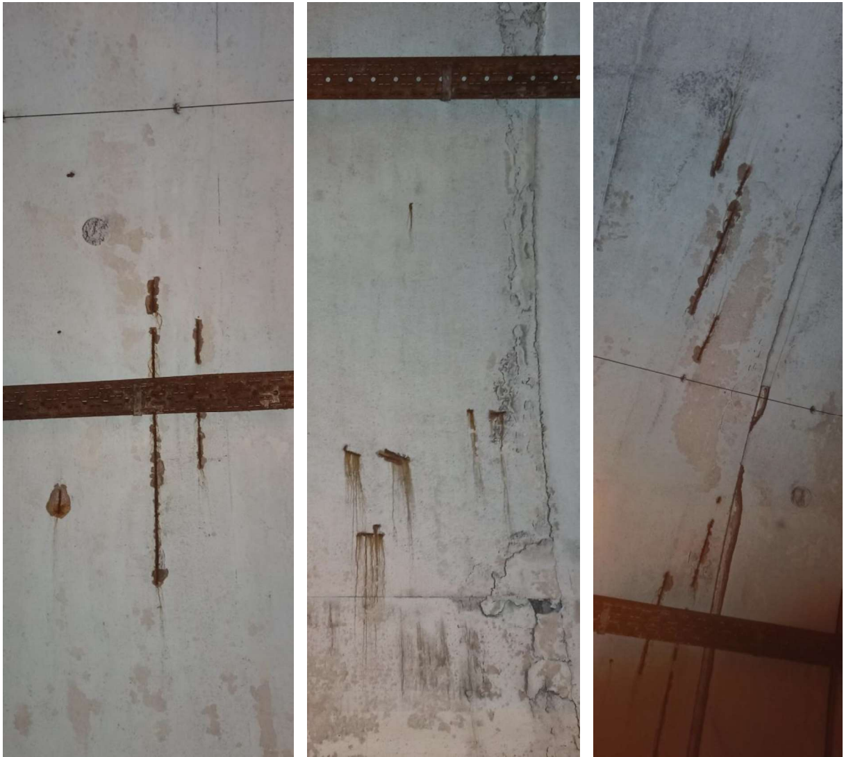
Slika 21: Kampada 45 - KOROZIJA, IZLOŽENA ARMATURA I ODLAMANJE BETONA
