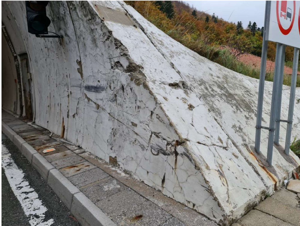
Slika 1: Ulazni portal - LJUŠTENJE BETONA, PUKOTINE
