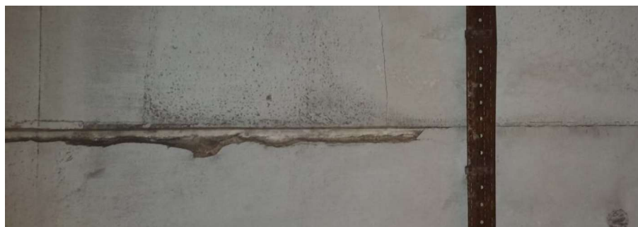
Slika 34: Kampada 78-79 - LJUŠTENJE BETONA NA SPOJNICI
