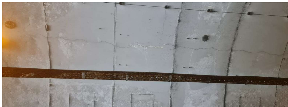
Slika 50: Kampada 140 - PUKOTINA, LJUŠTENJE PREMAZA
