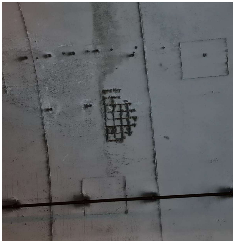
Slika 54: Kampada 153 - ARMATURA BEZ ZAŠITNOG SLOJA I LJUŠTENJE BETONA
