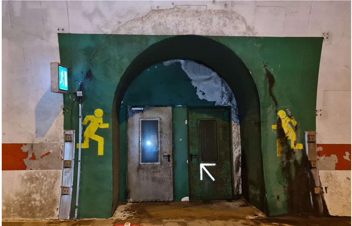
Slika 64: Kampada 197 - PUKOTINE, IZLUŽIVANJE I LJUŠTENJE PREMAZA
