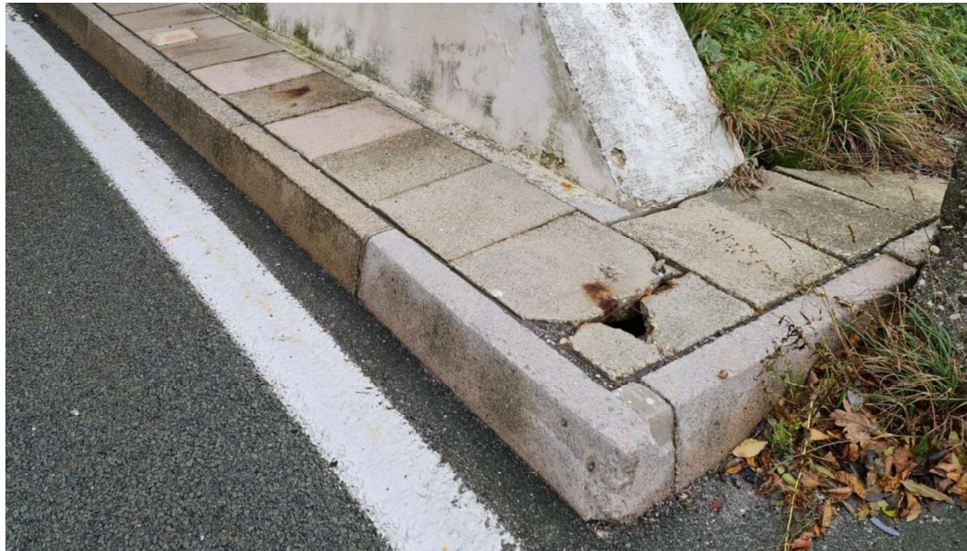
Slika 67: Izlazni portal - ODLAMANJE BETONSKE PLOČE HODNIKA
