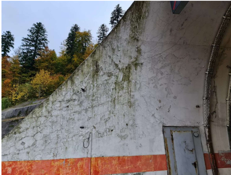
Slika 3: Ulazni portal - PUKOTINE, LJUŠTENJE PREMAZA
