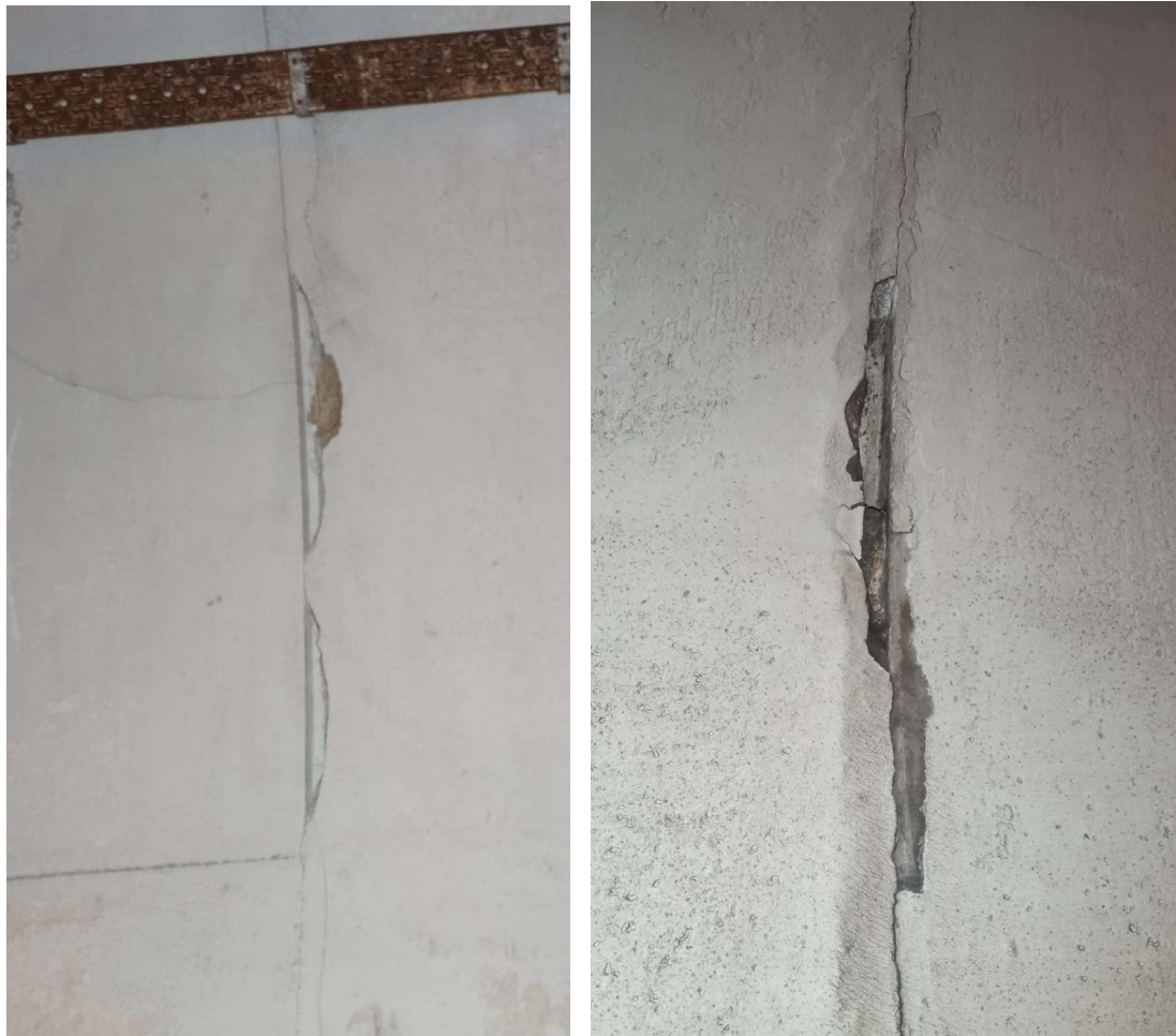
Slika 14: Kampada 18 - LJUŠTENJE BETONA NA SPOJNICI
