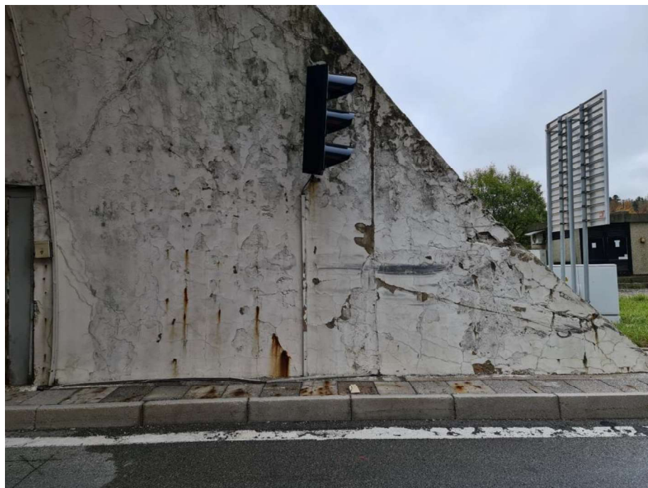
Slika 2: Ulazni portal - LJUŠTENJE BETONA, PUKOTINE I KOROZIJA
