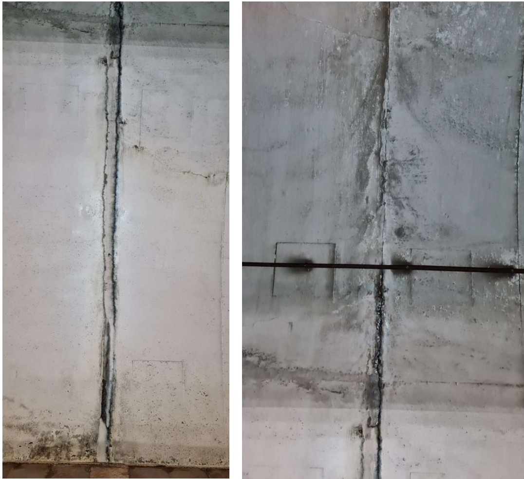
Slika 55: Kampada 162-163 - PUKOTINA, VLAŽENJE I ODLAMANJE BETONA
