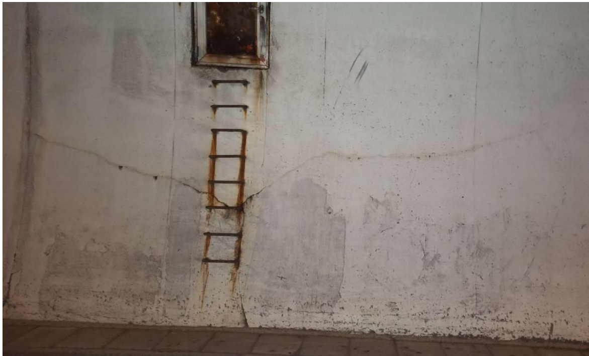
Slika 13: Kampada 9 - PUKOTINE I VLAŽENJE
