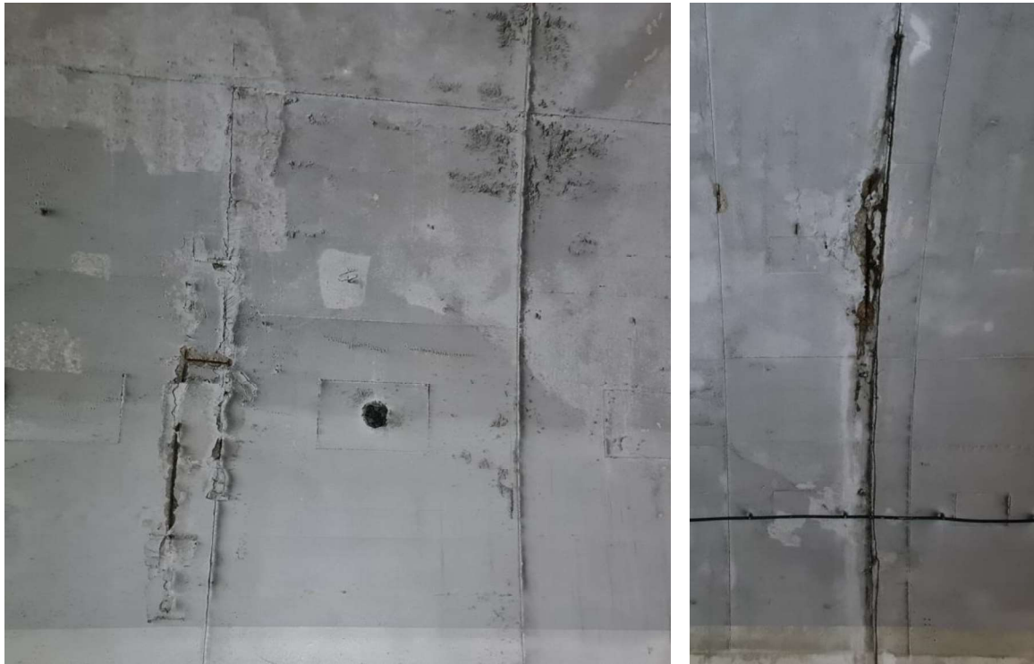
Slika 41: Kampada 105 - ARMATURA BEZ ZAŠTITNOG SLOJA, KOROZIJA I SEGREGACIJA
