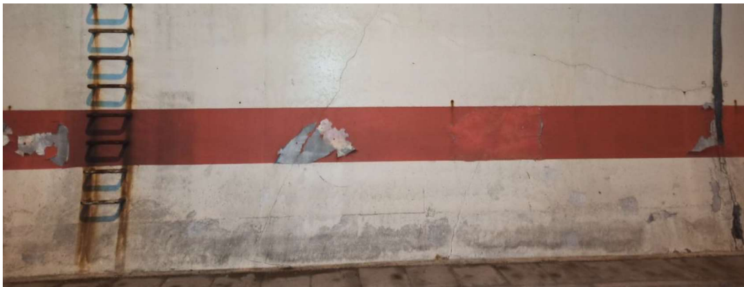
Slika 9: Kampada KOROZIJA I LJUŠTENJE PREMAZA 5
