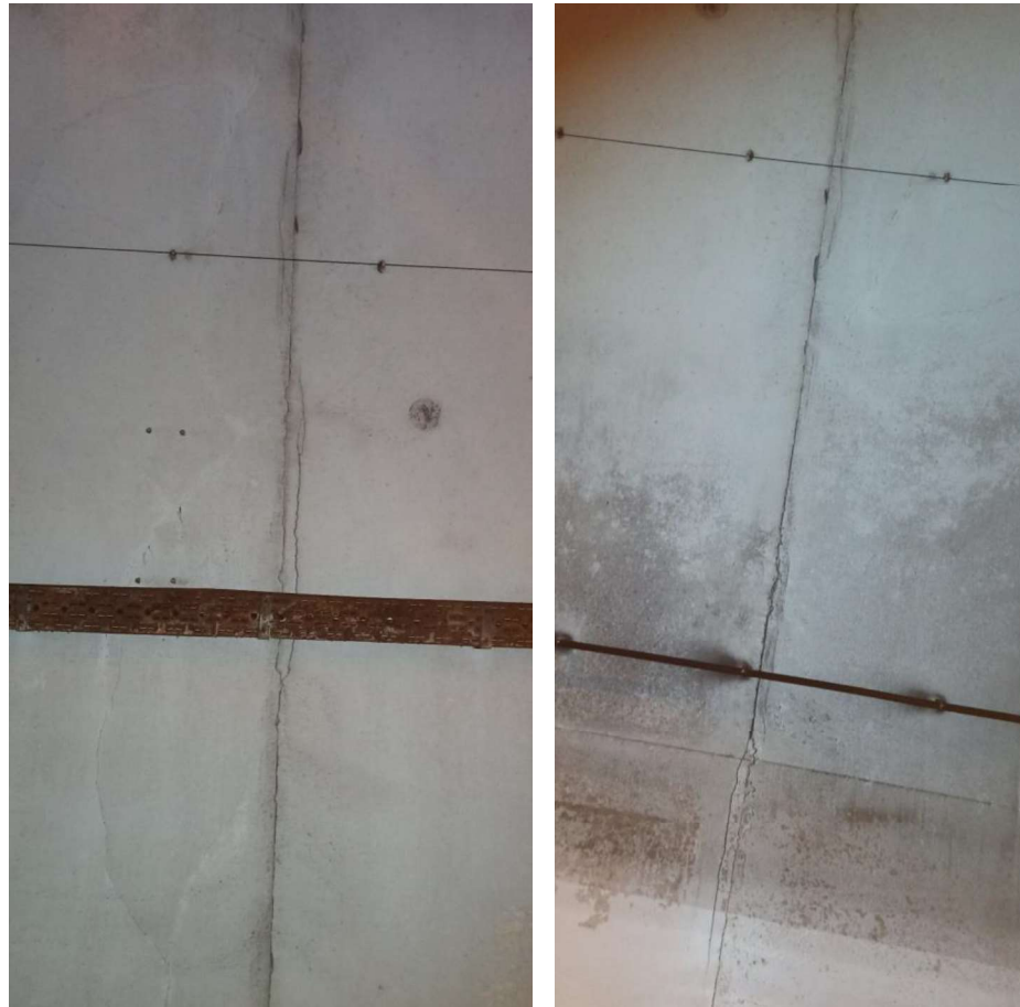
Slika 29: Kampada 66 - PUKOTINE NA SPOJNICI
