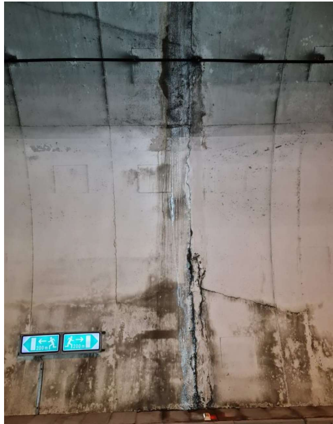
Slika 45: Kampada 127-128 - PUKOTINA, VLAŽENJE/ IZLUŽIVANJE
