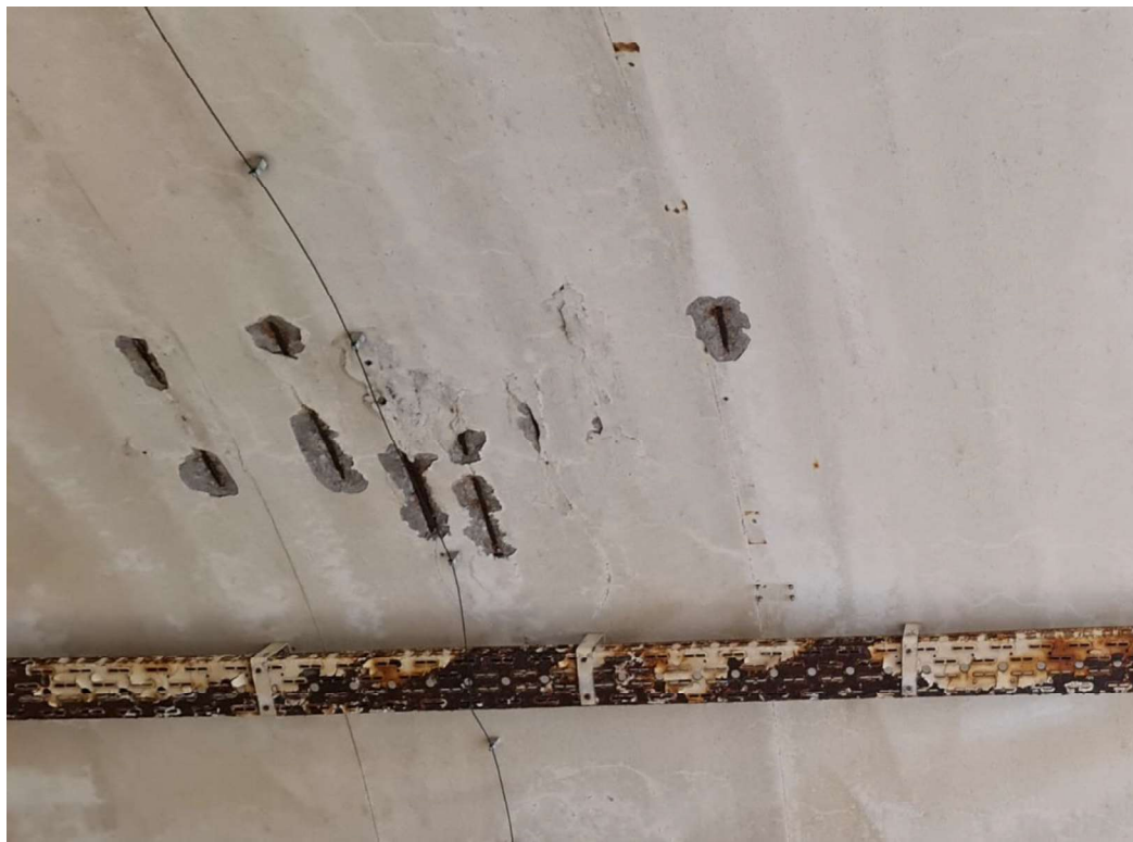
Slika 4: Kampada 2 - ARMATURA, ODLAMANJE BETONA
