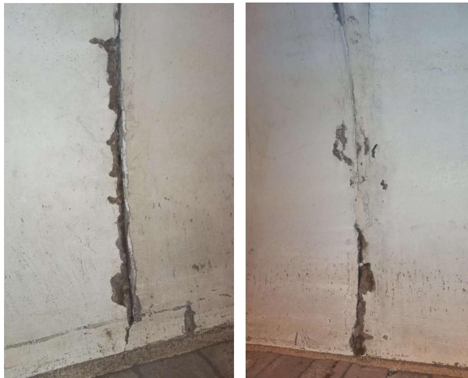
Slika 8: Kampada 4 - LJUŠTENJE I ODLAMANJE BETONA NA SPOJNICI
