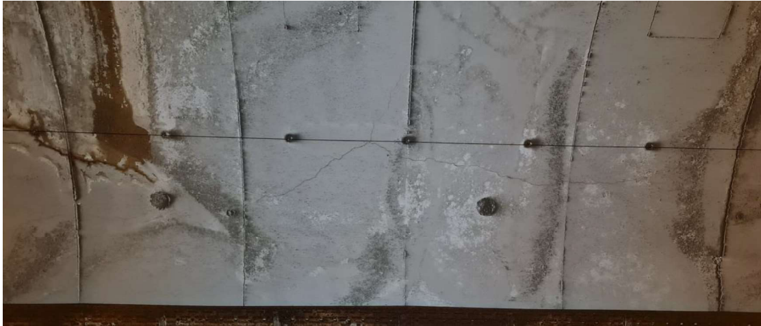
Slika 44: Kampada 121 - PUKOTINA I IZLUŽIVANJE
