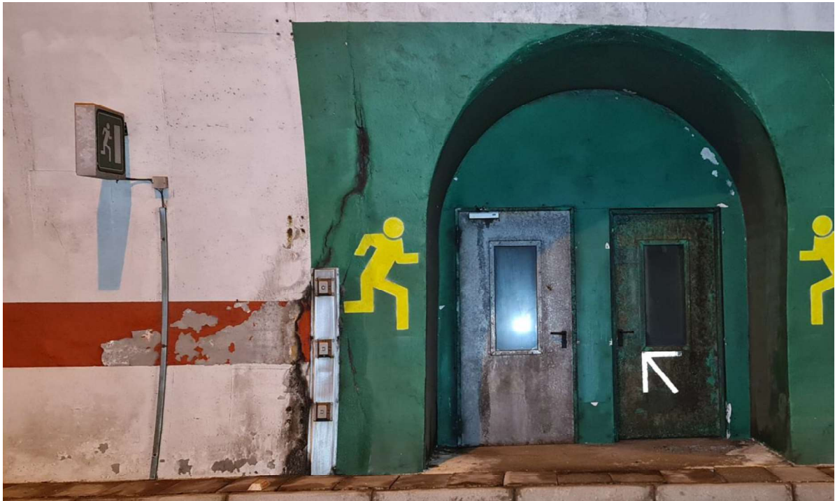
Slika 46: Kampada 130 - PUKOTINA, VLAŽENJE/ IZLUŽIVANJE I LJUŠTENJE PREMAZA
