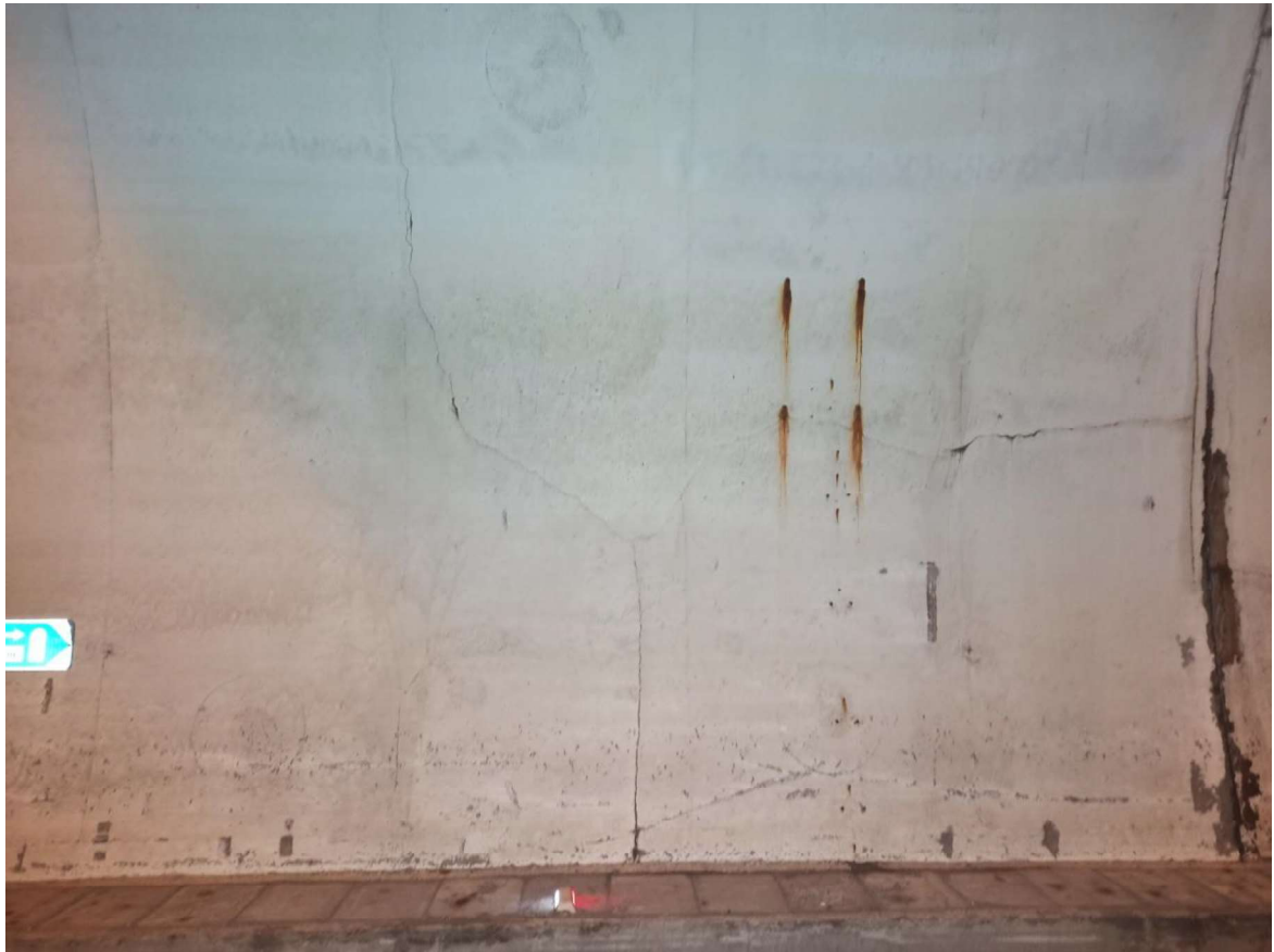
Slika 11: Kampada 6 - KOROZIJA I PUKOTINE
