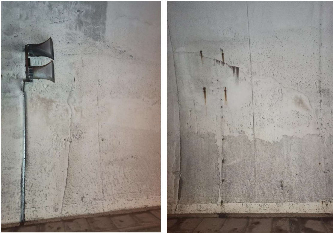
Slika 16: Kampada 22 - PUKOTINE I KOROZIJA
