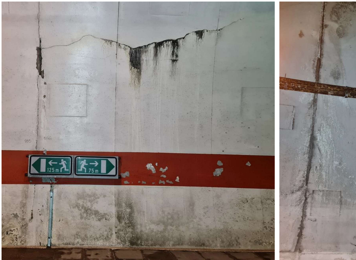
Slika 57: Kampada 166 - PUKOTINA, IZLUŽIVANJE I LJUŠTENJE PREMAZA I BETONA
