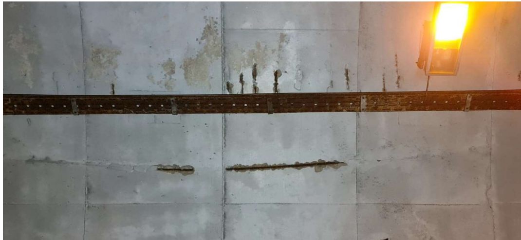
Slika 39: Kampada 97 - LJUŠTENJE BETONA I ARMATURA BEZ ZAŠITNOG SLOJA
