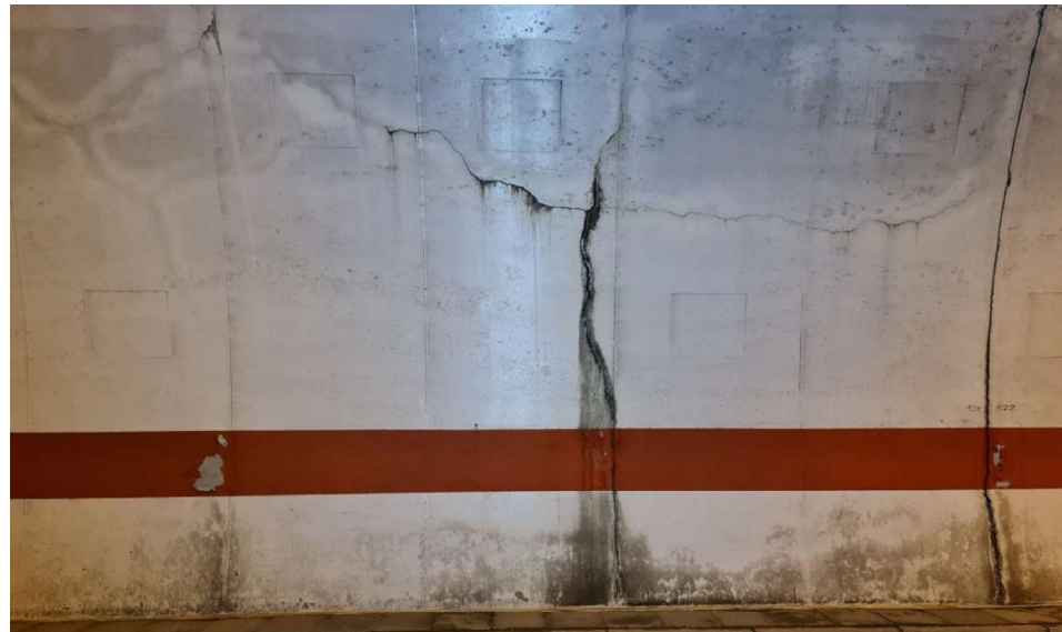
Slika 43: Kampada 121 - PUKOTINA I IZLUŽIVANJE
