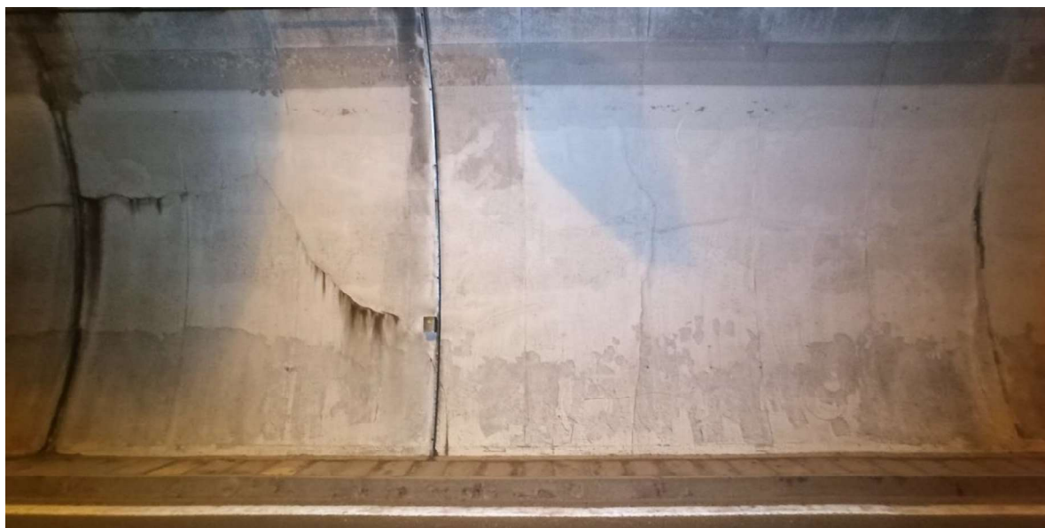
Slika 15: Kampada 18 - PUKOTINE I VLAŽENJE
