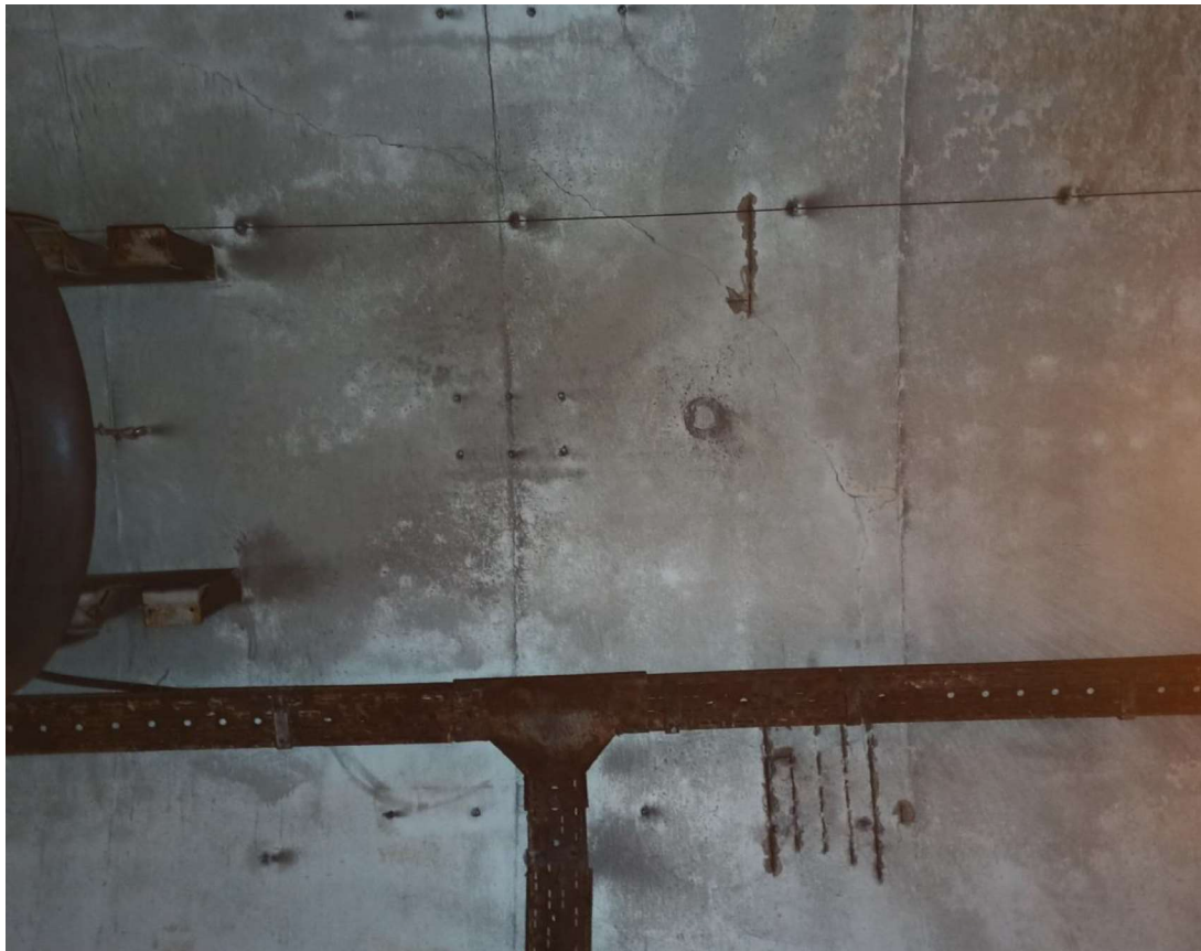
Slika 36: Kampada 90 - PUKOTINA, IZLOŽENA ARMATURA I LJUŠTENJE BETONA
