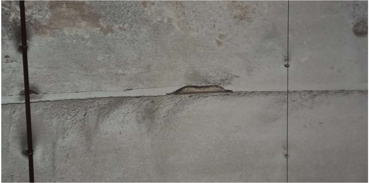
Slika 18: Kampada 35 - ODLAMANJE BETONA
