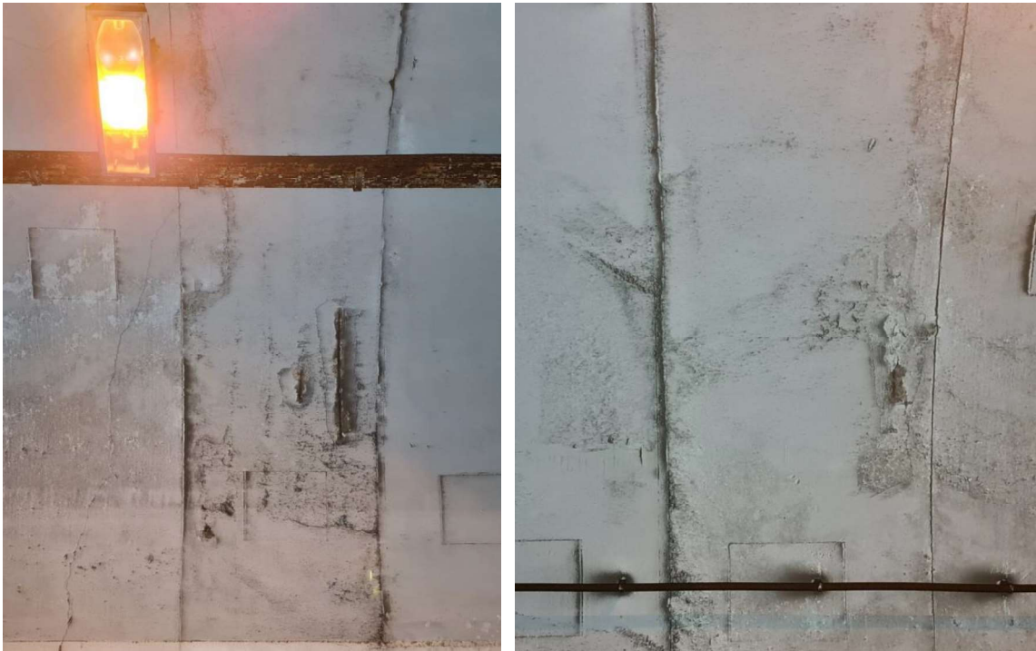
Slika 51: Kampada 146 - SEGREGACIJA I ARMATURA BEZ ZAŠTITNOG SLOJA
