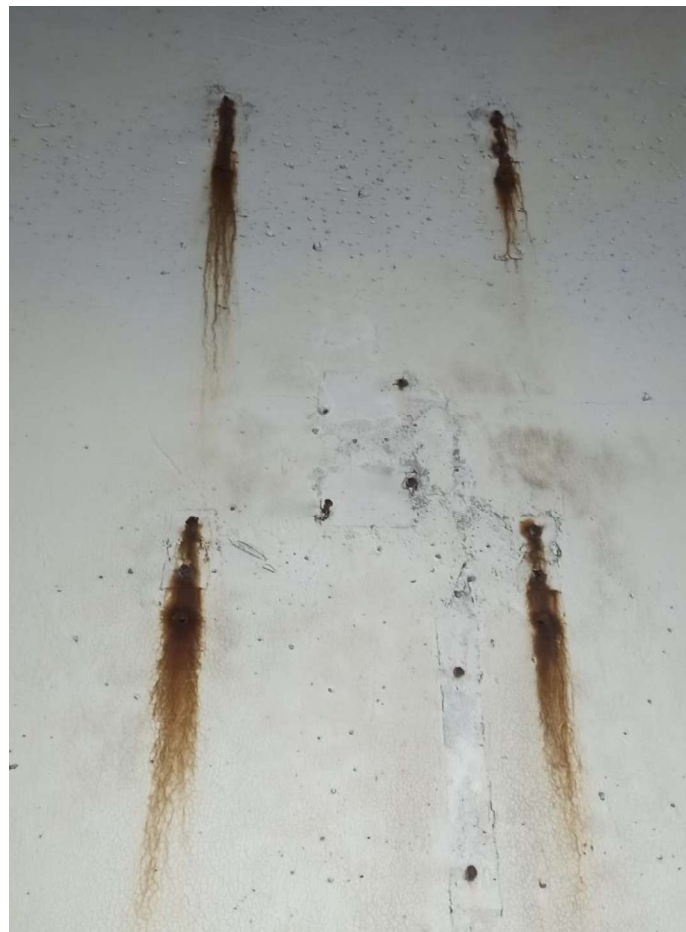
Slika 32: Kampada 73 - MRLJE OD KOROZIJE
