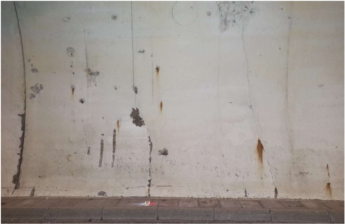
Slika 7: Kampada 3 - PUKOTINE, LJUŠTENJE PREMAZA I MRLJE OD KOROZIJE
