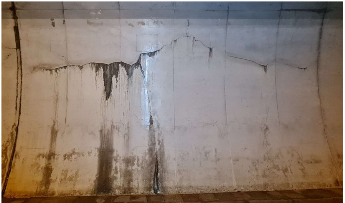
Slika 62: Kampada 188 - PUKOTINA, IZLUŽIVANJE
