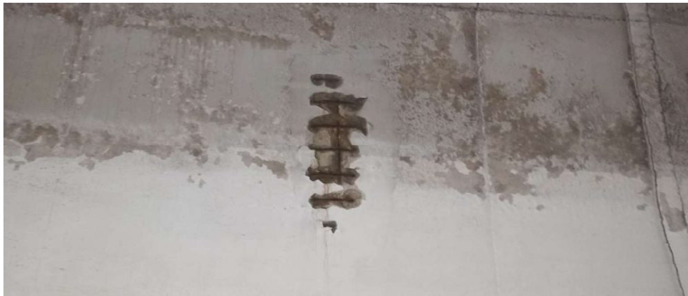
Slika 27: Kampada 63 - ARMATURA BEZ ZAŠITNOG SLOJA I LJUŠTENJE BETONA
