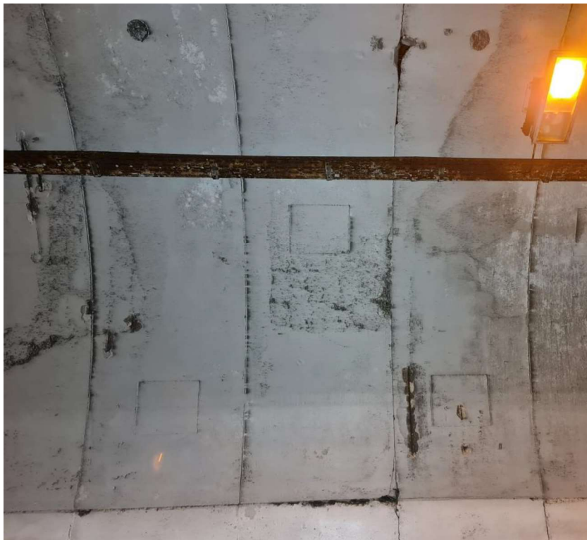
Slika 52: Kampada 147 - SEGREGACIJA, ARMATURA BEZ ZAŠTITNOG SLOJA I ODLAMANJE BETONA
