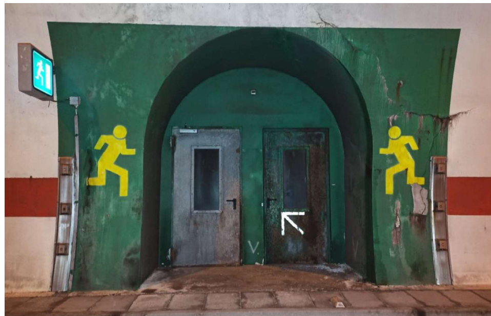
Slika 23: Kampada 57 - PUKOTINE, LJUŠTENJE BETONA I PREMAZA, LUŽENJE
